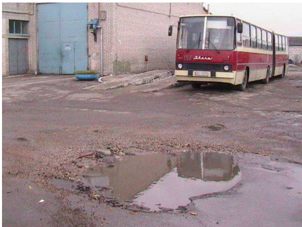
Fot. 15. Zajeżdźnia Zakładu Komunikacji Miejskiej PGK - stan techniczny nawierzchni.
