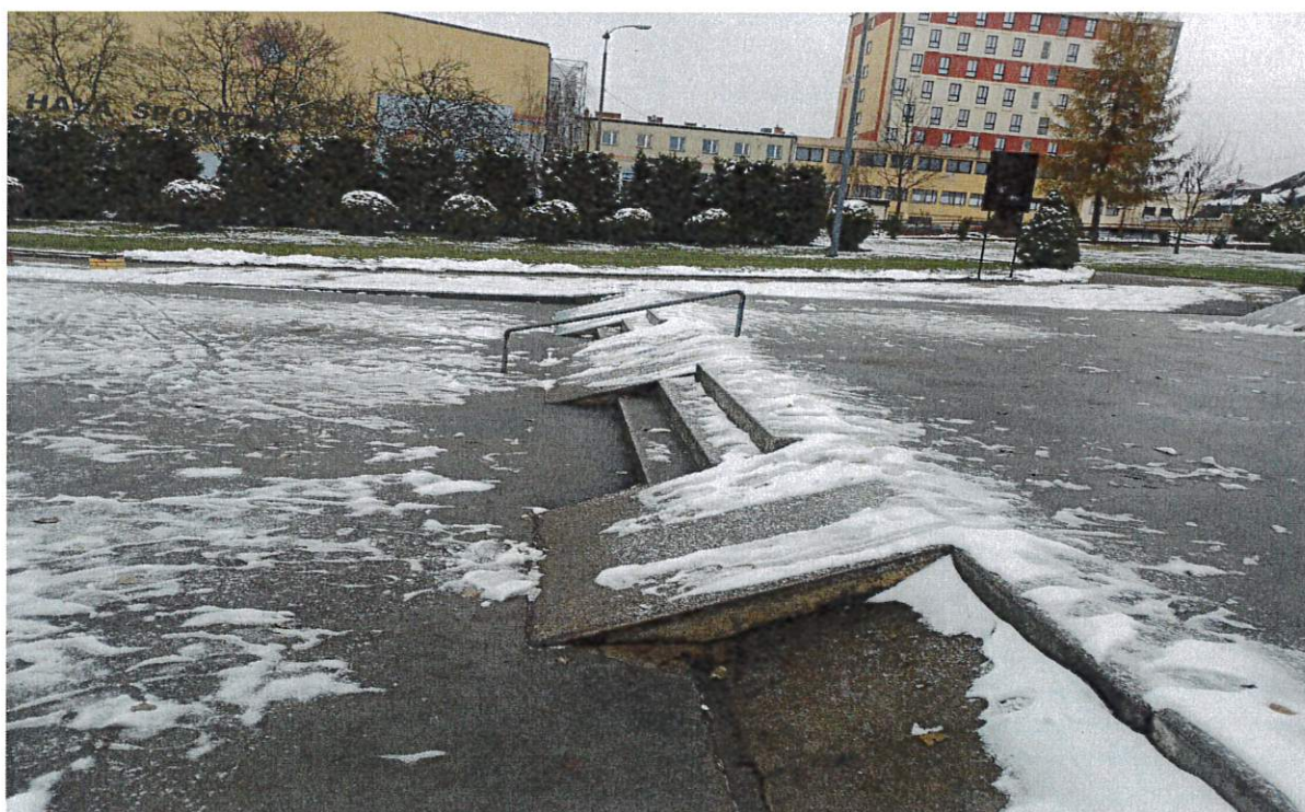
Fot nr 7 Schody, poręcze i grinboxy na łączeniu nawierzchni
