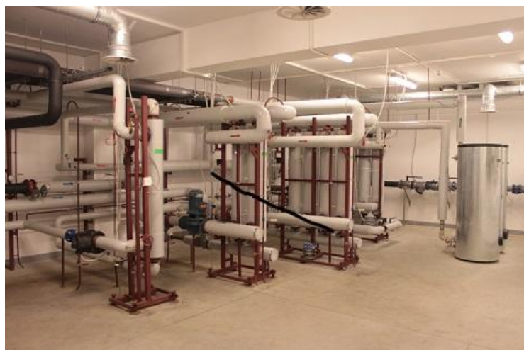
Węzeł cieplny, fot. archiwum PEC w Suwałkach Sp. z o.o.
