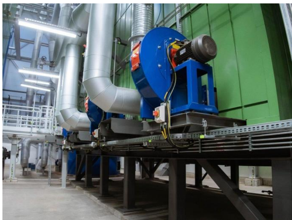
Palenisko kotła biomasowego fot. Archiwum PEC w Suwałkach Sp. z o.o
