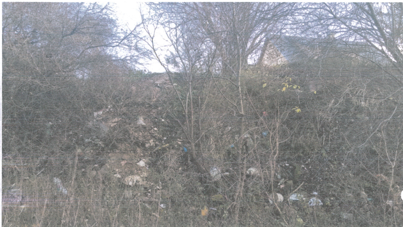
Fot 4. Skarpa wzdłuż przedłużenia ulicy Łanowej
