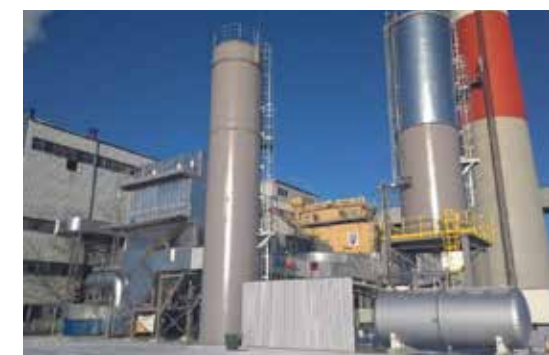
Instalacja oczyszczania spalin, fot. z archiwum Przedsiębiorstwa Energetyki Ciepłej w Suwałkach Sp. z o.o.
