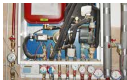
Węzeł ciepły w budynku jednorodzinnym, fot. z archiwum Przedsiębiorstwa Energetyki Ciepłej w Suwałkach Sp. z o.o.
