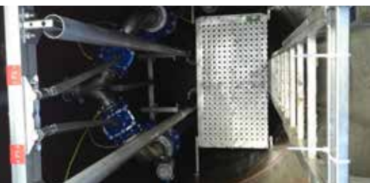
Przepompownia odcieków na terenie oczyszczalni ścieków w Suwałkach fot. z archiwum PWiK w Suwałkach Sp. z o.o.
