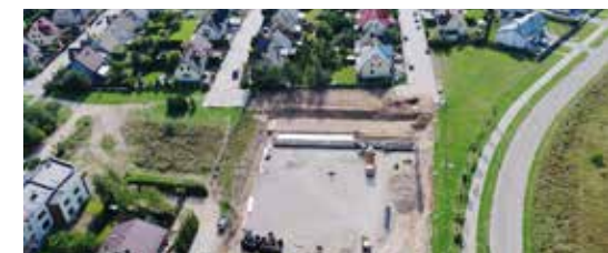
Budowa zbiornika retencyjno-rozsączającego na wody opadowe - Osiedle Hańcza, fot. z archiwum Przedsiębiorstwa Wodociągów i Kanalizacji w Suwałkach Sp. z o.o.
