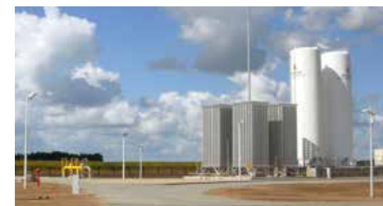
Instalacja spalania biomasy, fot. z archiwum Przedsiębiorstwa Energetyki Ciepłej w Suwałkach Sp. z o.o.
