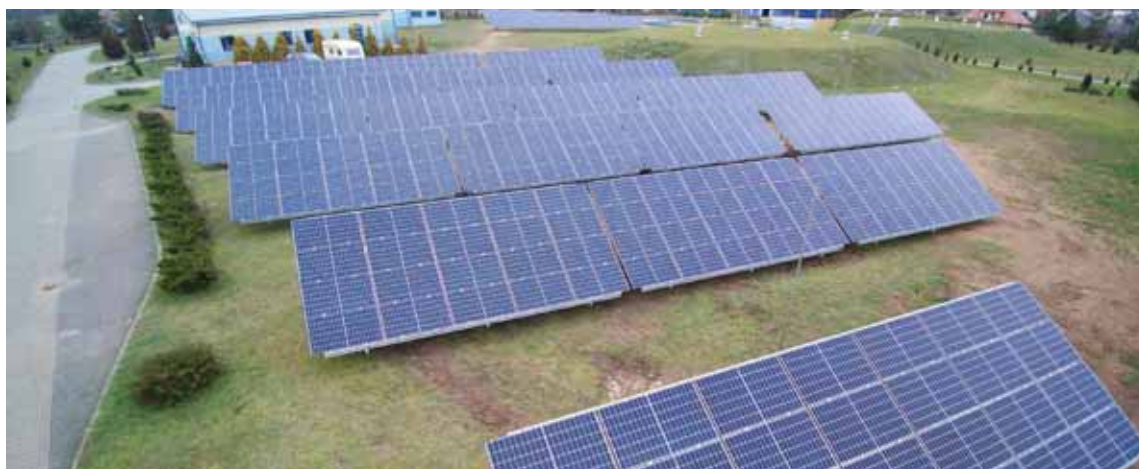
Instalacja fotowoltaiczna przy ul. gen. W. Sikorskiego 1, fot. Przedsiębiorstwo Wodociągów i Kanalizacji w Suwałkach
