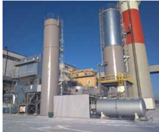
Instalacja oczyszczania spalin, fot. Przedsiębiorstwo Energetyki Ciepłej w Suwałkach
