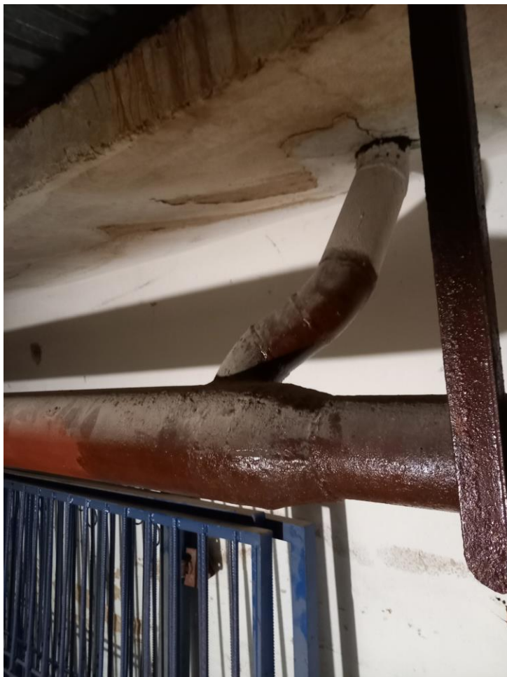
Instalacja przelewowa na poziomie basenu i podbasenia do wymiany – korozja i przecieki
