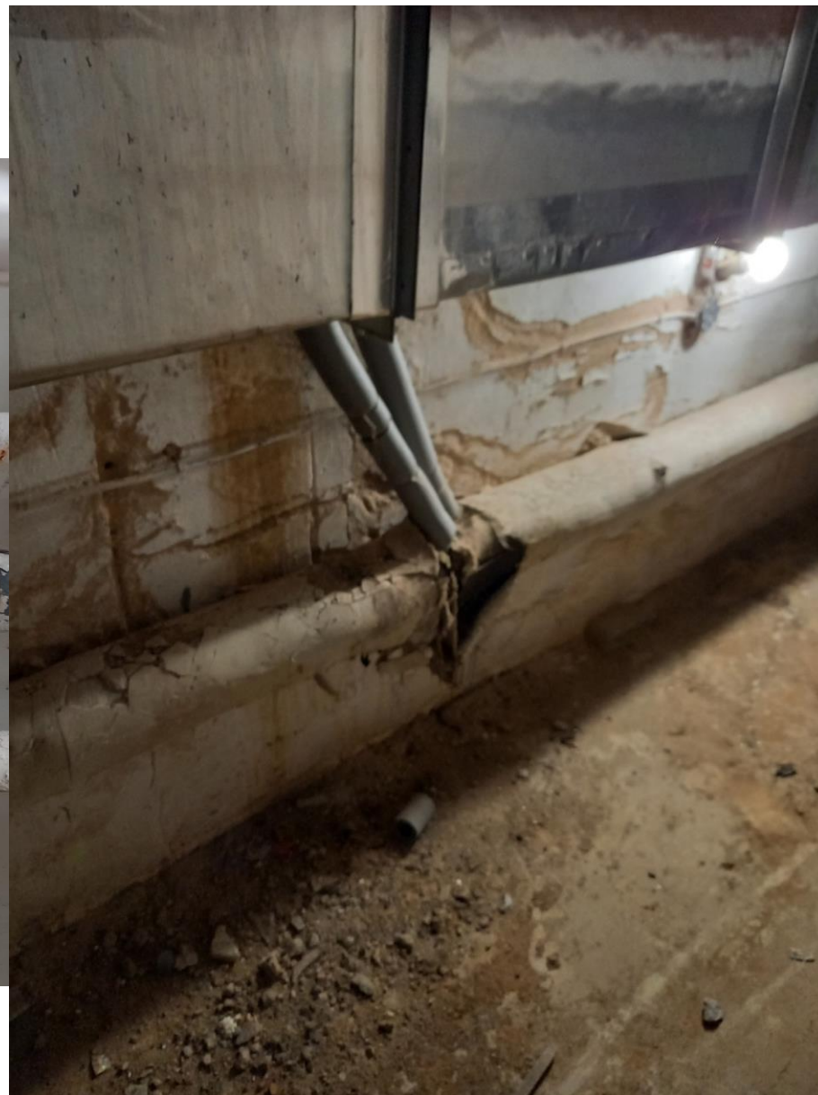
Instalacja instalacja c.o. – na części basenowej korozja pionów i grzejników- do wymiany lub likwidacji
