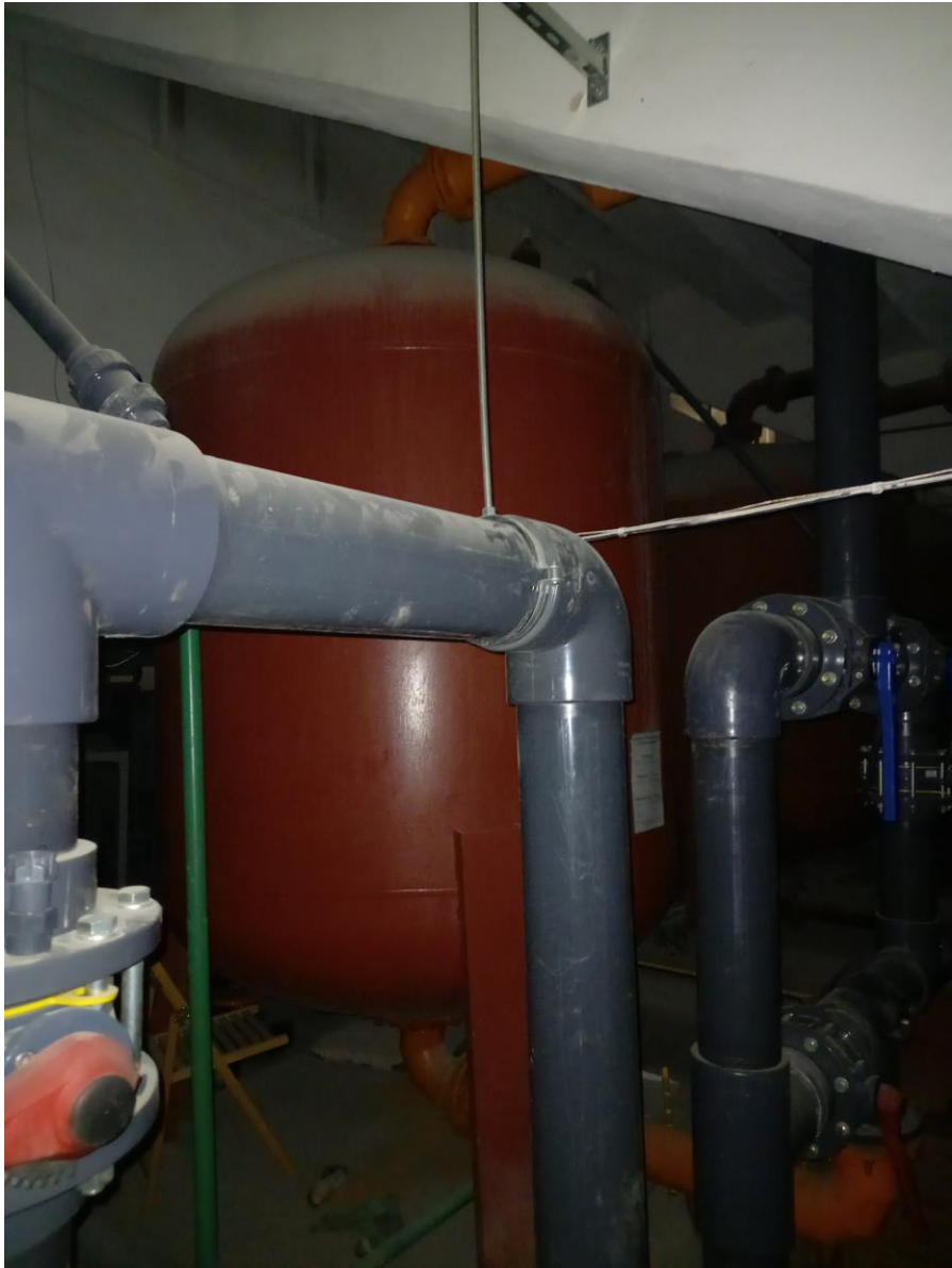
Urządzenia technologii basenowej- filtry , odżelaziacze- zły stan techniczny
