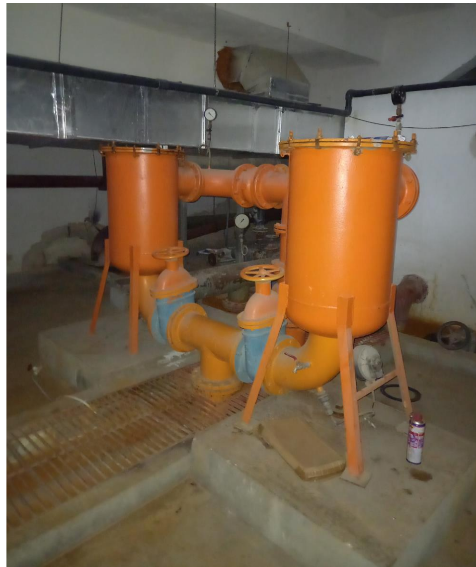
Urządzenia technologii basenowej-zasowy i filtrootmulniki, hydroforzły stan techniczny
