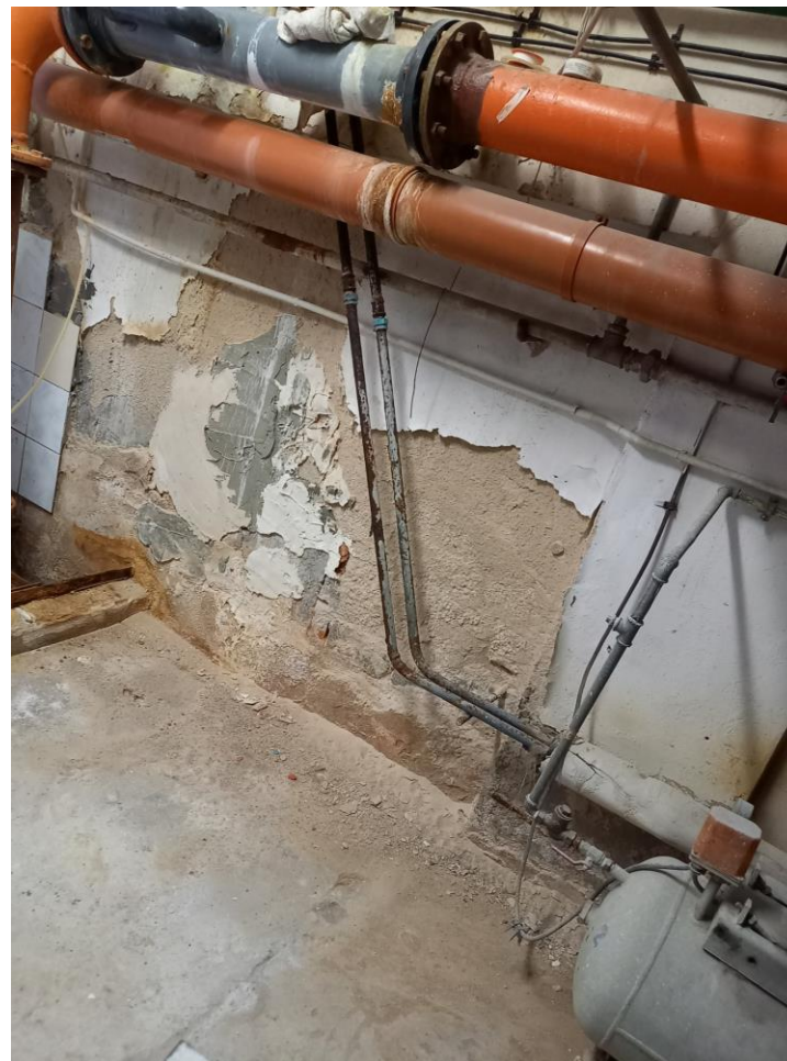
Instalacja przelewowa na poziomie basenu i podbasenia do wymiany – korozja i przecieki
