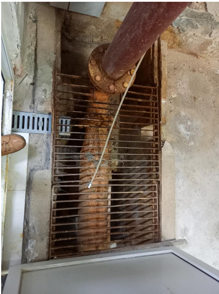
Instalacja doprowadzająca uzdatnioną wodę z basenu – do wymiany – korozja rur i krutek
