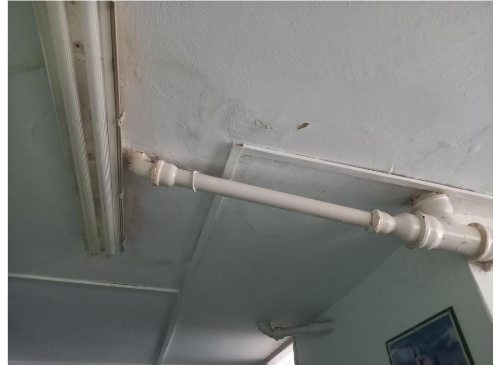
Instalacja kanalizacji sanitarnej na poziomie szatni i w piwnicy – do wymiany - zacieki na ścianach i sufitach
