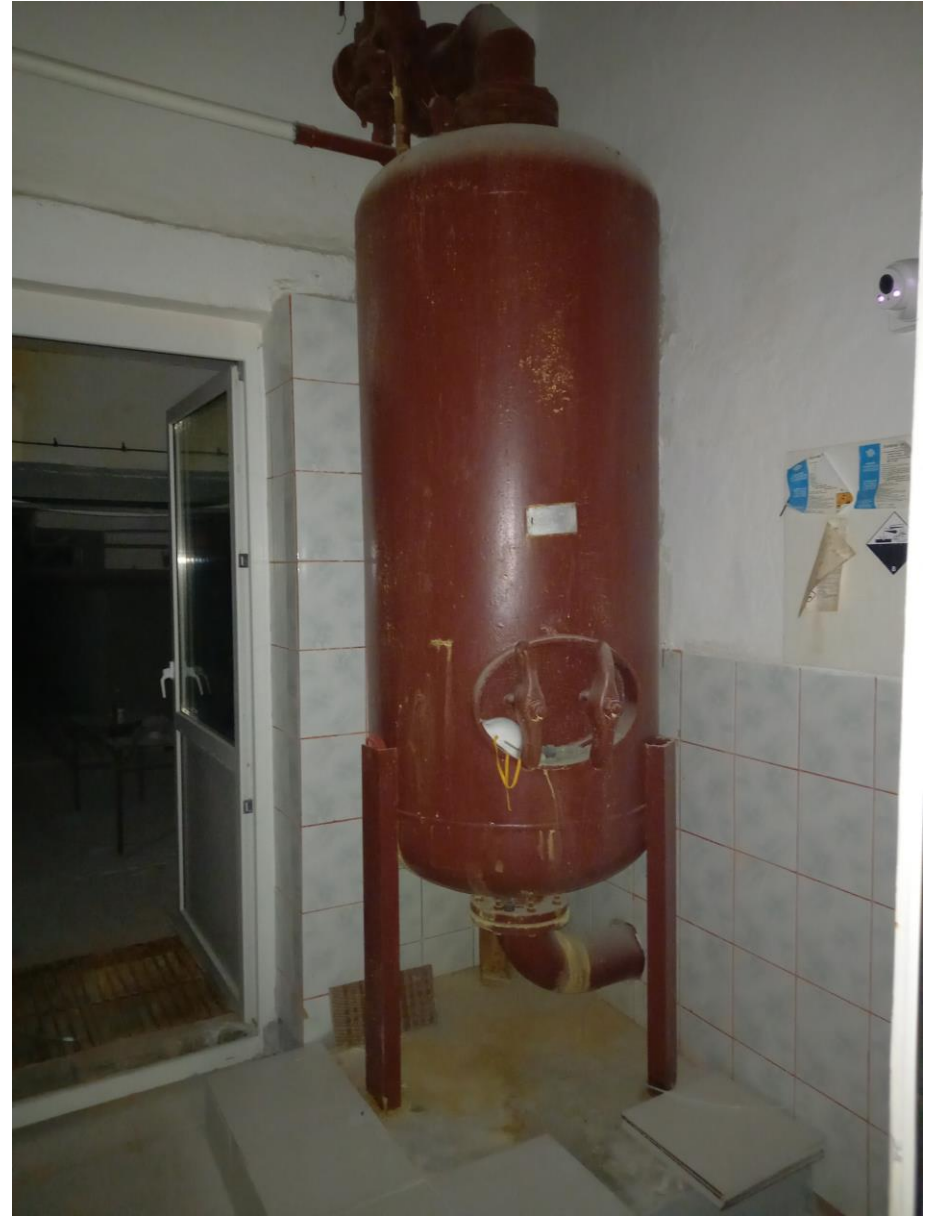
Zbiorniki, zasuwki, orurowanie- zły stan techniczny do likwidacji
