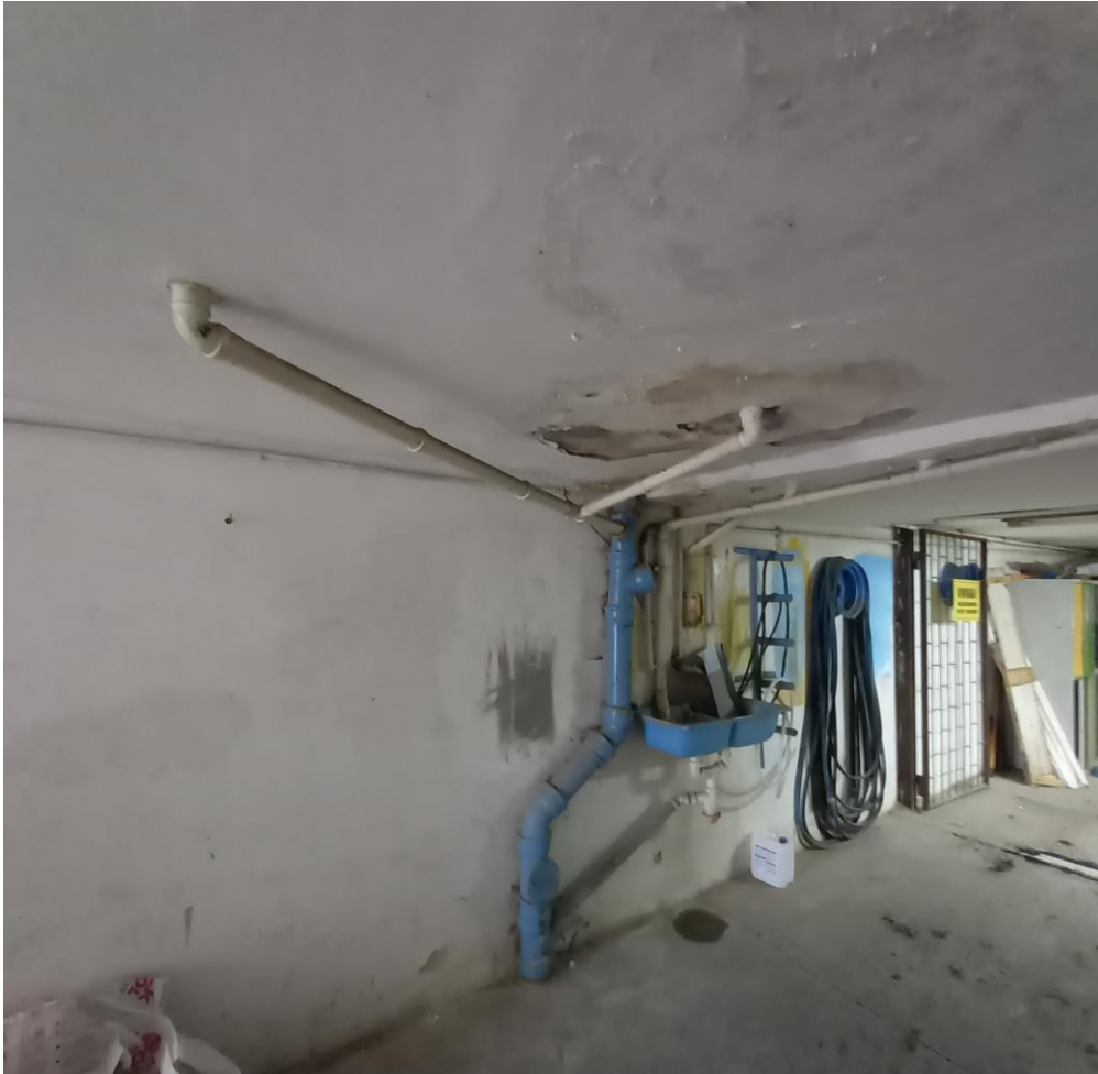
Instalacja kanalizacji sanitarnej na poziomie basenu – do wymiany - zacieki na ścianach i sufitach
