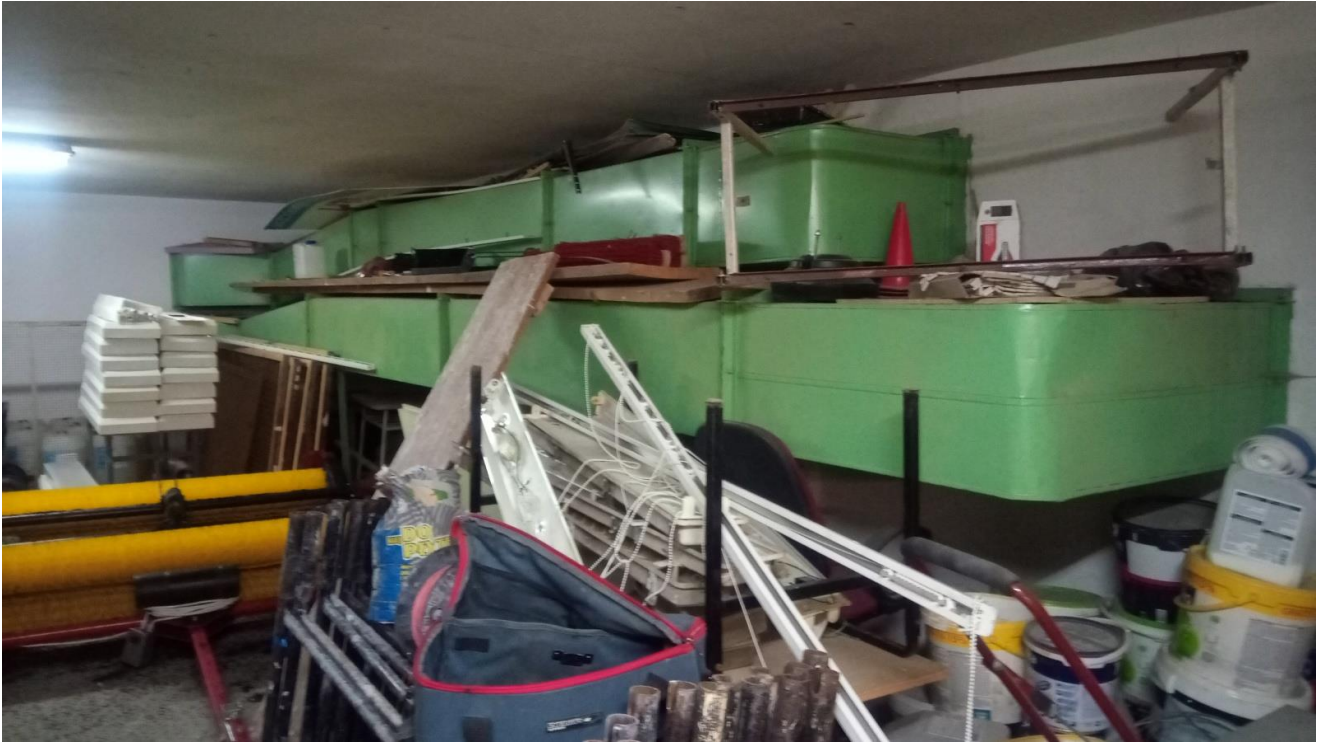
Istniejąca niedziałająca instalacja wentylacji – do likwidacji
