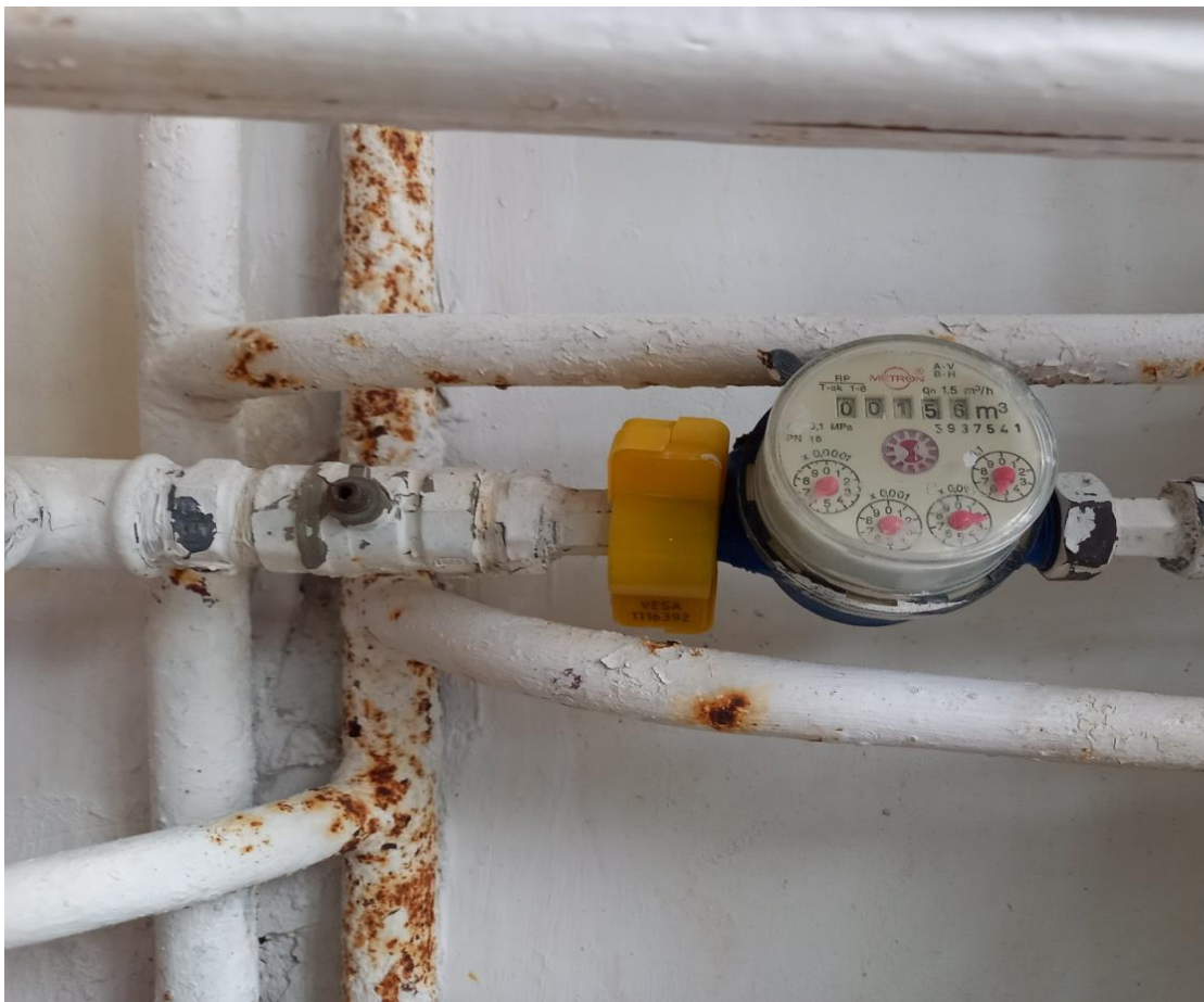
Instalacja wodna , instalacja c.o. – piony i grzejniki – na części basenowej korozja pionów i grzejników- do wymiany lub likwidacji
