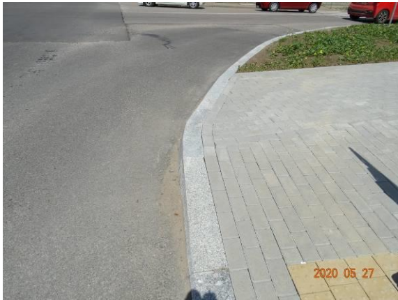
58. Nieprawidłowy łuk na skrzyżowaniu ul. Utrata z ul. Pogodną KT (w kierunku wschodnim).
