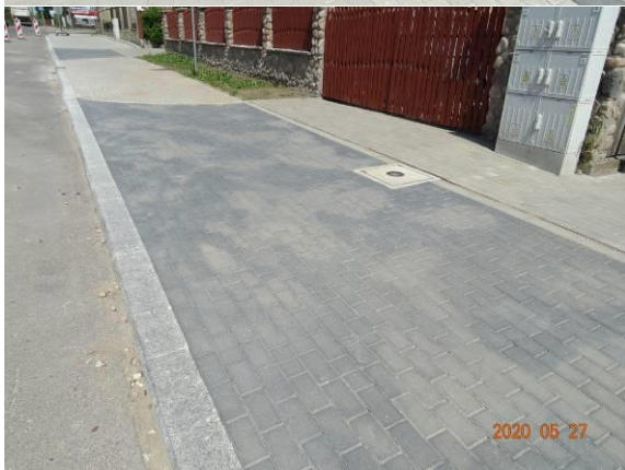
59. Brak spoinowania kostki na wjeździe podwójnym przy ul. Utrata 93 i ul. Utrata 91.
