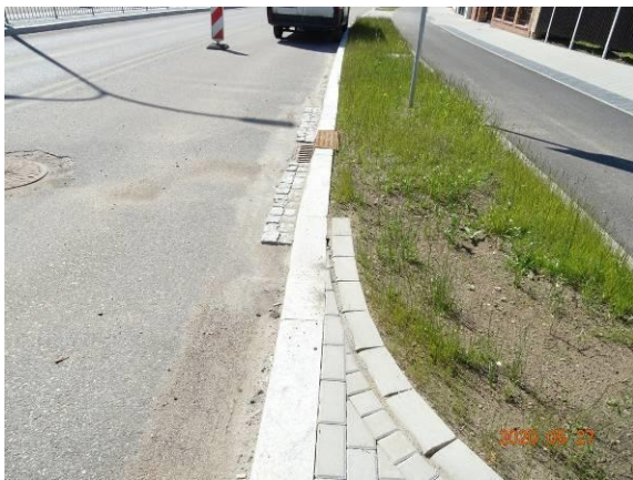
63. Niewłaściwe spoinowanie kostki przy wpustach (cieki).
