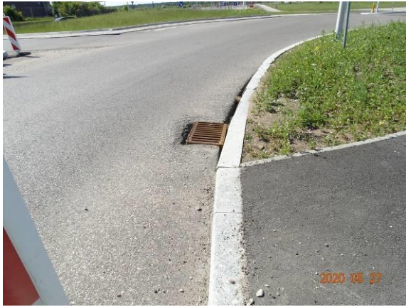
65. Uszkodzone krawężniki kamienne i mocowanie wpustu na skřęcie w ul. 5 KD.
