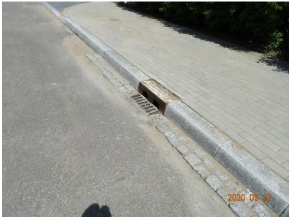
60. Brak właściwej spoiny na cieku z kostki granitowej przy wpusście
