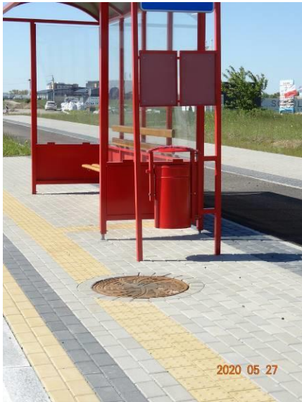
70. Brak spoinowania kostki na peronie przystanku przy zatoce ITD.
