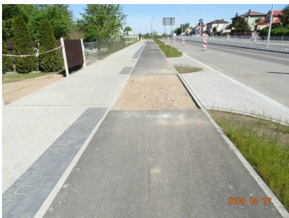
64. Brak spoinowania kostki betonowej na chodniku ul. Utrata PT – wlot ul. A. Piłsudskiej strona zachodnia.
