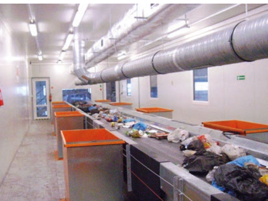
Linia sortownicza odpadów komunalnych, fot. Przedsiębiorstwo Gospodarki Odpadami w Suwałkach.
