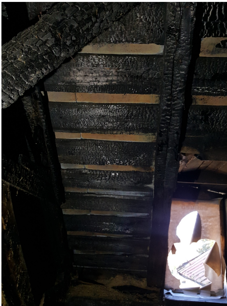
Rys. 7. Więżba dachowa uszkodzona pożarem – konieczna wymiana więźby
