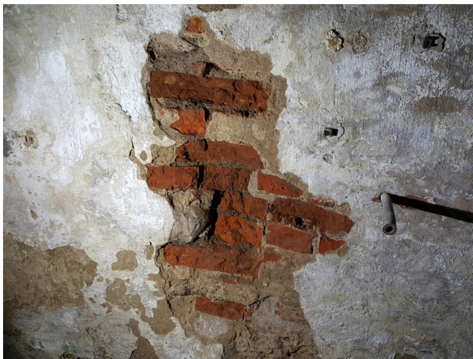
Rys. 4. Ściana fundamentowa – zawilgocenie cegły i jej płatkowanie
