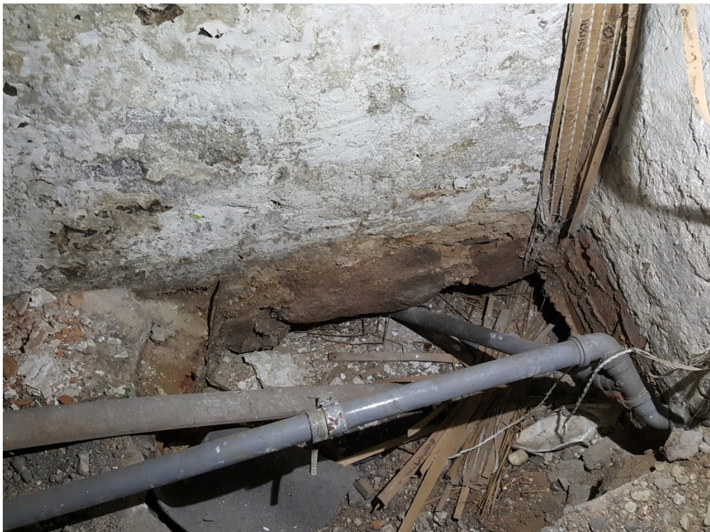
Rys. 3. Odkrywka fundamentów – brak izolacji pionowej i poziomej
