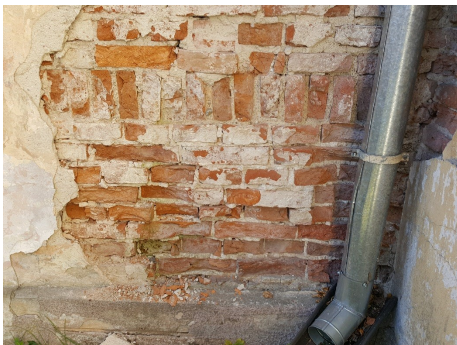
Rys. 5. Ściana zewnętrzna murowana – płatkowanie cegły
