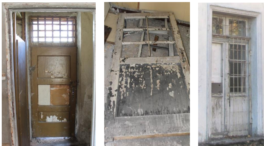
Fot.17 Zniszczona stolarka drzwiowa
