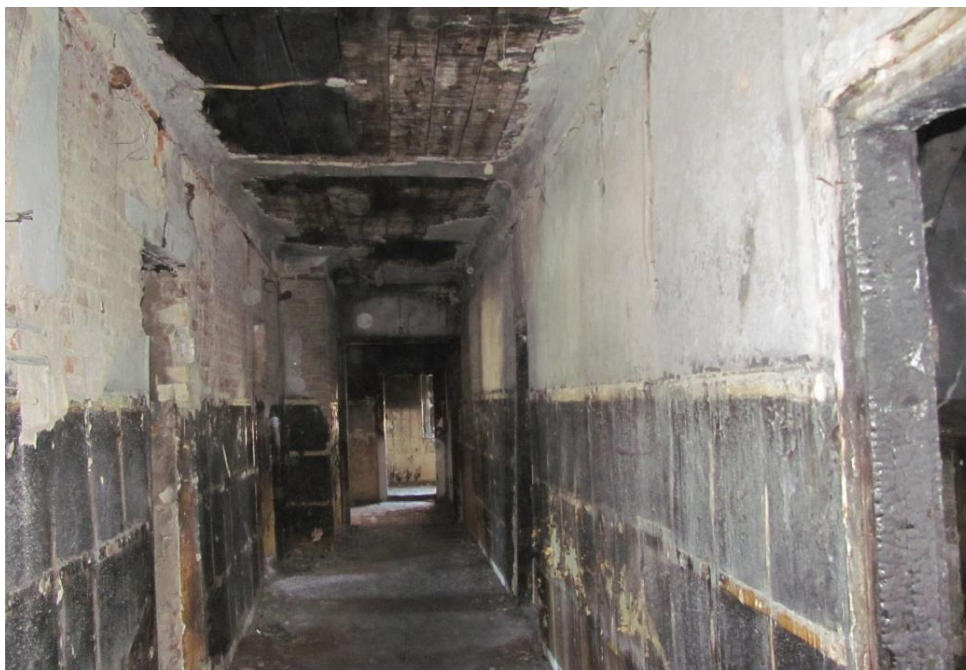
Fot.7 Uszkodzenia tynków wewnętrznych przez sole i temperaturę wywołaną pożarem , degradacja podsufitki z desek
