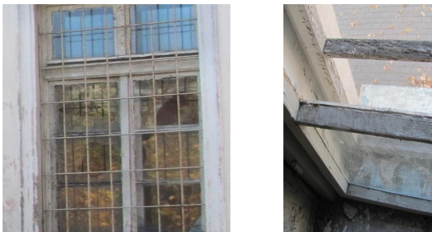
Fot.16 Uszkodzona stolarka okienna
