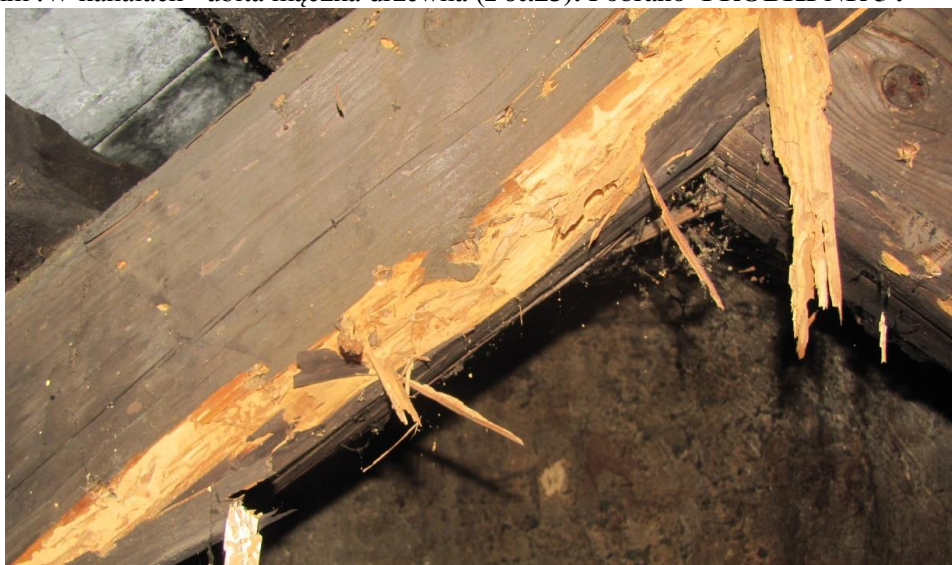
Fot.23 Uszkodzona krokiew przez Spuszczela pospolitego ( Hylotrupes baj. )
