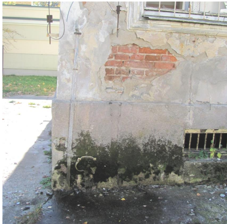
Fot.5 Uszkodzenie tynku i muru ściany zewnętrznej oficyny, intensywny rozwój glonów ( algae ) -kolor c.zielony . Pobrano PRÓBKĘ NR 7 do dalszych badań
