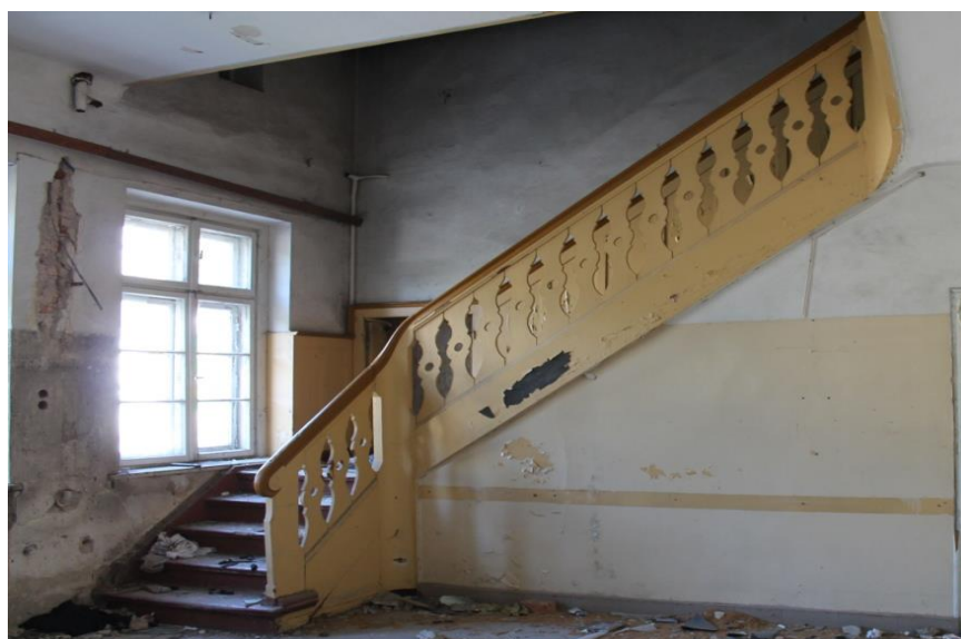
Fot.15 Schody drewniane na piętro zaatakowana przez owady Kołatki uparte ( Anobium pertinax ) Próbka NR 6
