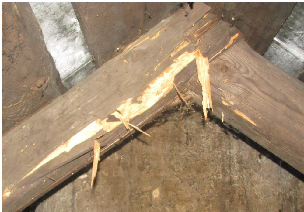
Fot.9 Krokwie uszkodzone przez owady (tu: Spuszczel pospolity ) W prawym górnym rogu krokiew spalona w pożarze
