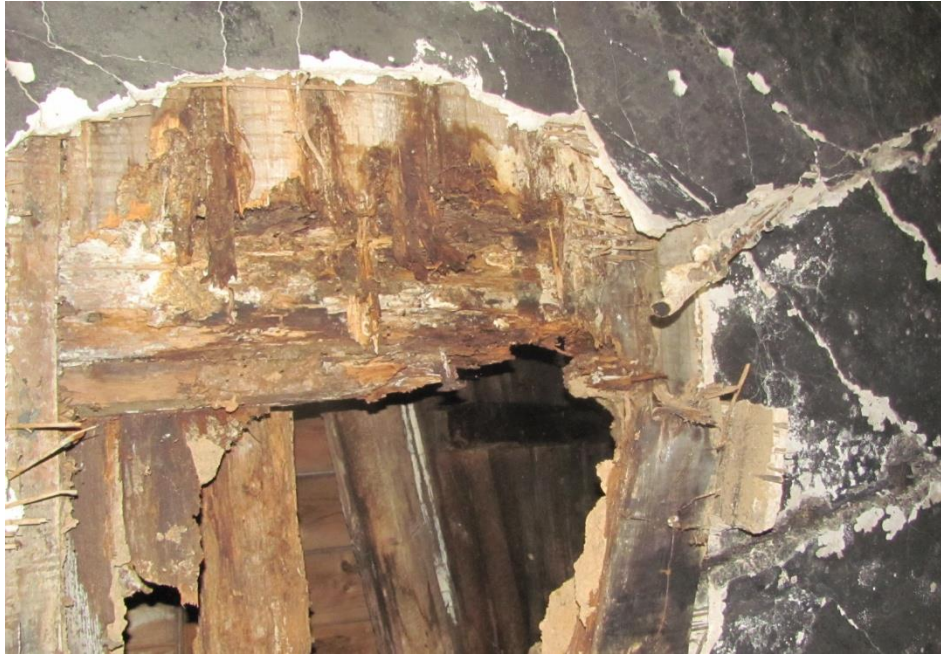
Fot. 21 Belka stropowa i deskowanie podsufitki zniszczone przez Grzyb domowy właściwy ( Serpula lacrymans ). Proces tzw. „zgnikizny brunatnej” drewna konstrukcyjnego . Pobrano PRÓBKĘ NR 1
