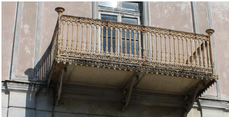
Fot.19 Balkon od strony ul. Kościuszki w złym stanie technicznym
