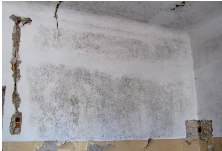
Fot.20 Na tynku ściany parteru grzybnia koloru czarnego ( Aspergillus )
