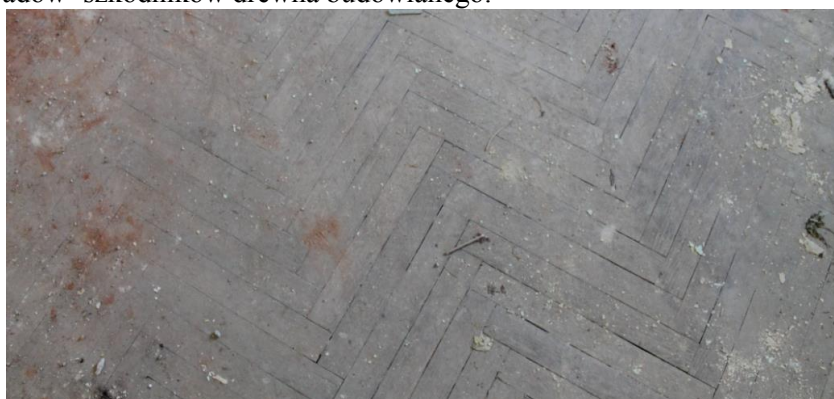
Fot.11 Zdeprawowany parkiet drewniany podłogi na parterze budynku
