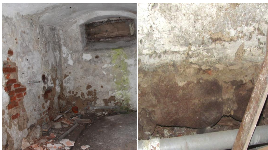
Fot.3 Ubytki lica cegiel i spoin w murze fundamentowym piwnicy Pod okienkiem zielone naloty glonów ( algae )W spoinach i na licu cegiel muru znaleziono sznury grzyba koloru szarego i białego
