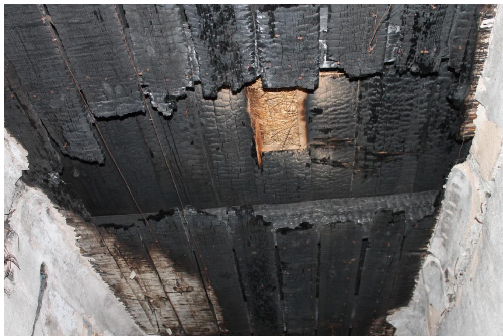
Fot.14 Strop drewniany nad piętrem (korytarz) z widocznymi zniszczeniami elementów drewnianych przez pożar
