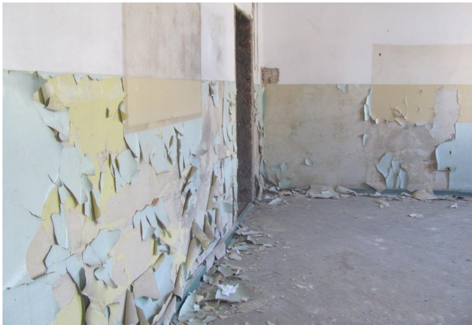
Fot. 6 Uszkodzone powłoki malarskie i tynki na parterze na skutek krystalizacji soli i działania grzybów rozkładu pleśniowego
