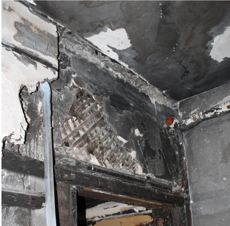
Fot. 18 Ścianka działowa na piętrze po pożarze
