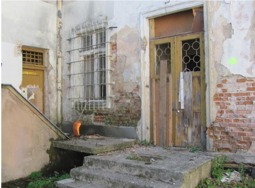
Fot.4 Ubytki lica muru ściany zewnętrznej od zaplecza budynku Uszkodzona stolarka okienna i drzwiowa
