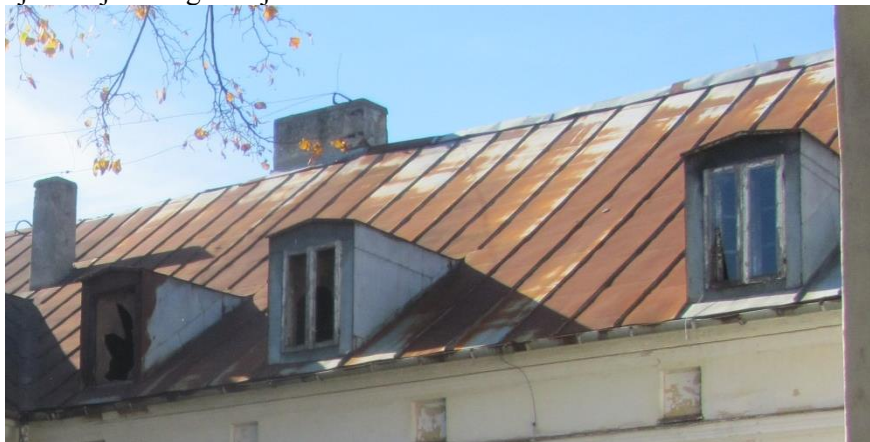
Fot.10 Skorodowane pokrycie z blach na połaci dachowej
