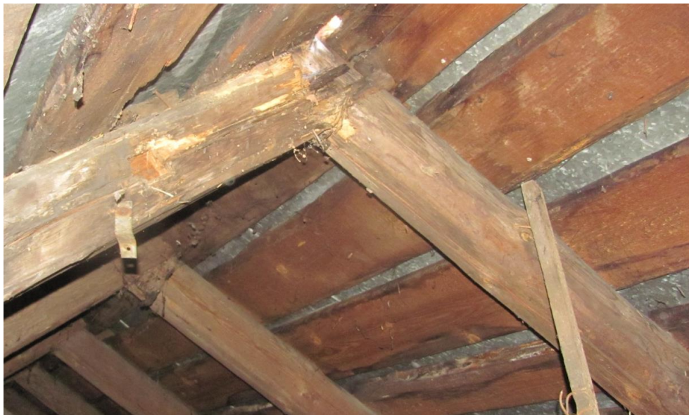
Fot.22 Grzyb Powłocznik gładki ( Corticium laeve ) na deskowaniu połaci dachu Oficyny – PRÓBKA NR 3 oraz Grzyb domowy biały ( Poria vaporaria ) na krokwiach szczytu
