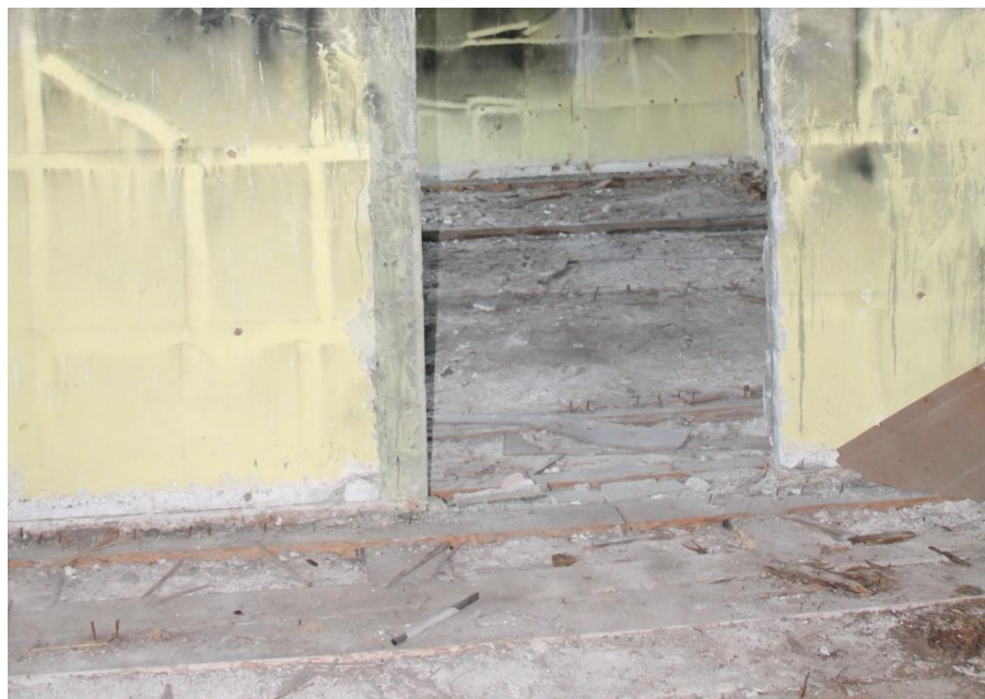
Fot.14 Odsłonięte belki drewnianego stropu nad parterem po zerwaniu podłóg
