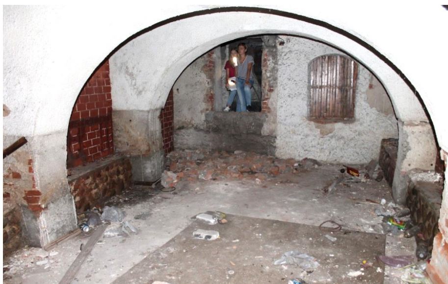
Fot. 13 Łukowe podparcia stropu nad piwnicą nr 01 .Uszkodzona przez krystalizację soli i korozję biologiczną cegła w filarach .
