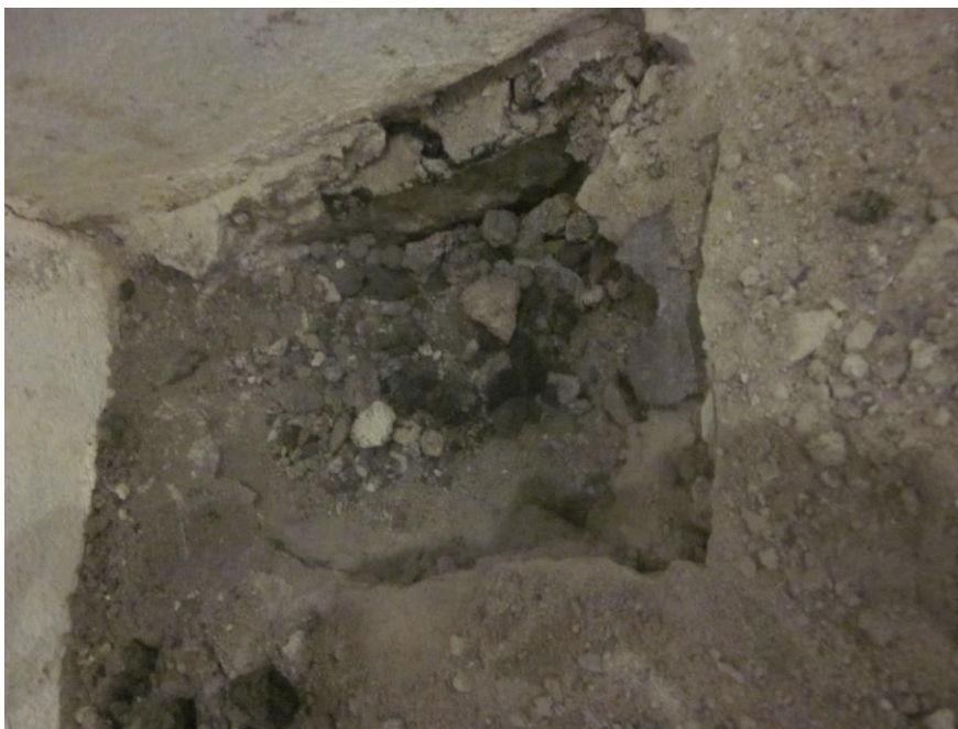
Zdjęcie własne odkrywki podłogi na styku ściany nośnej i działowej
