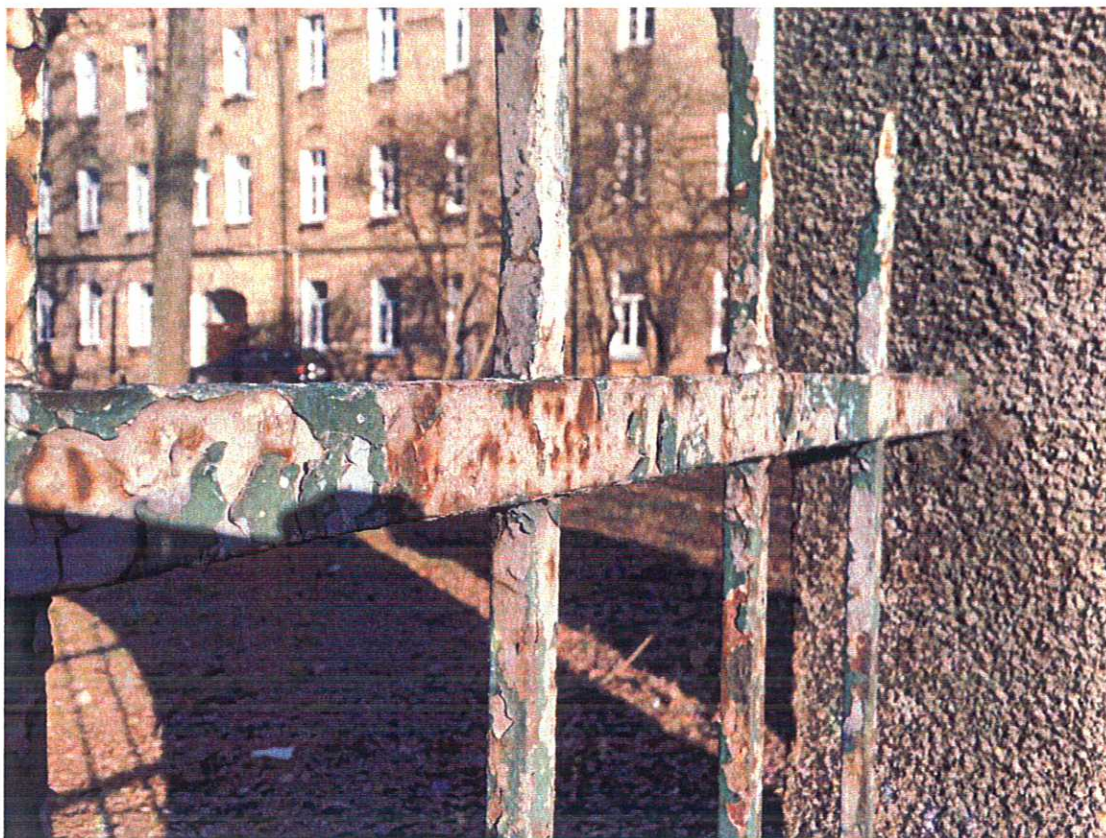
fot. nr 5 – Widoczne zniszczenia na ażurowym zdobieniu z metalu.
