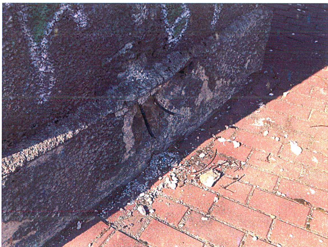
fot. nr 14 – Pozostałości po instalacjach elektrycznych. Ubytki do uzupełnienia.
