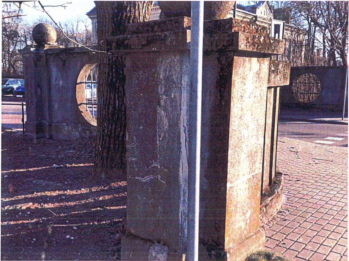
fot. nr 7 – Północna część bramy. Widoczne spękania w skrajnej kolumnie.
