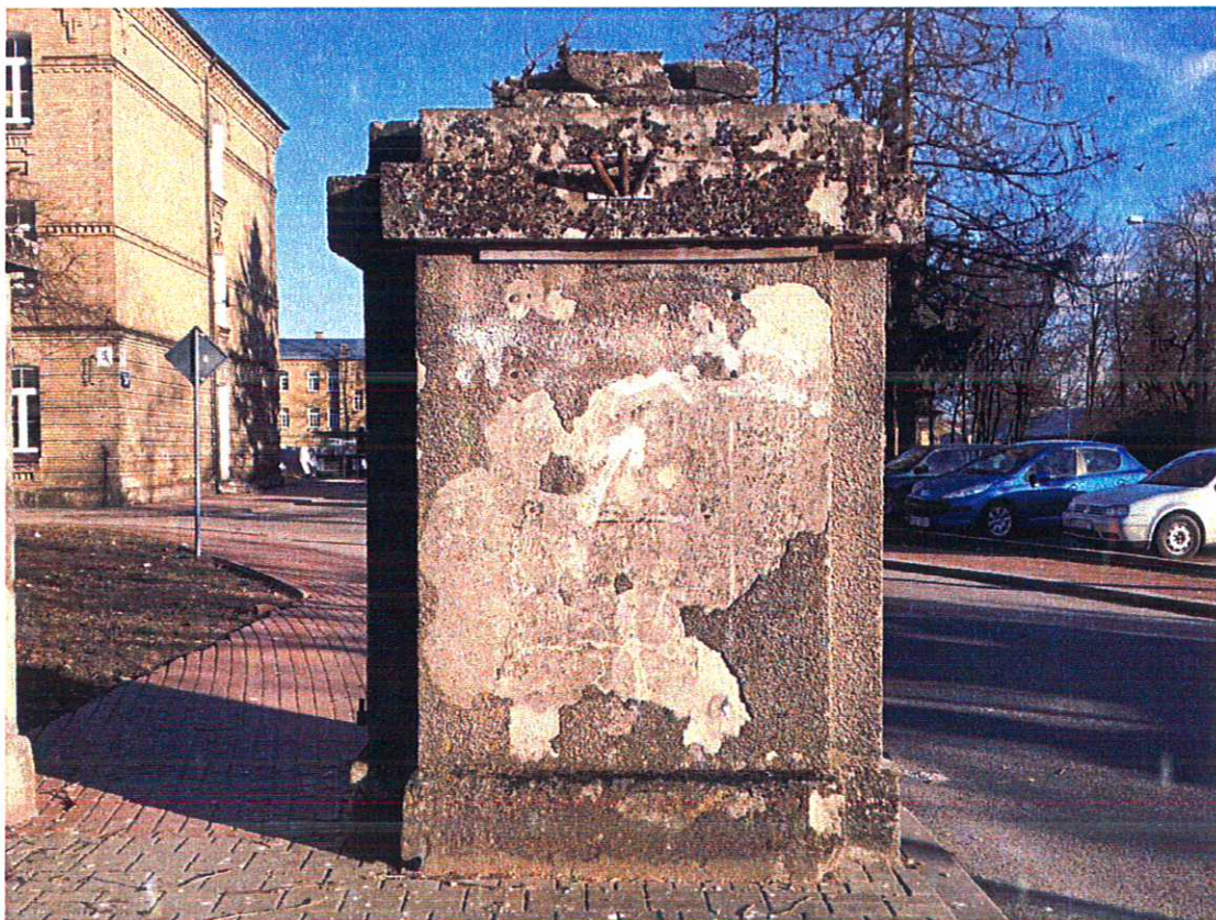
fot. nr 6 – Północna kolumna z cokołem. Cokół pod rzeźbę zniszczony, ubytki w tynku.
