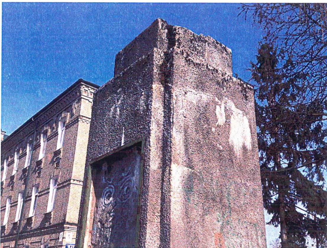
fot. nr 23 – Cokół pomnika. Widoczne spękania betonu.
