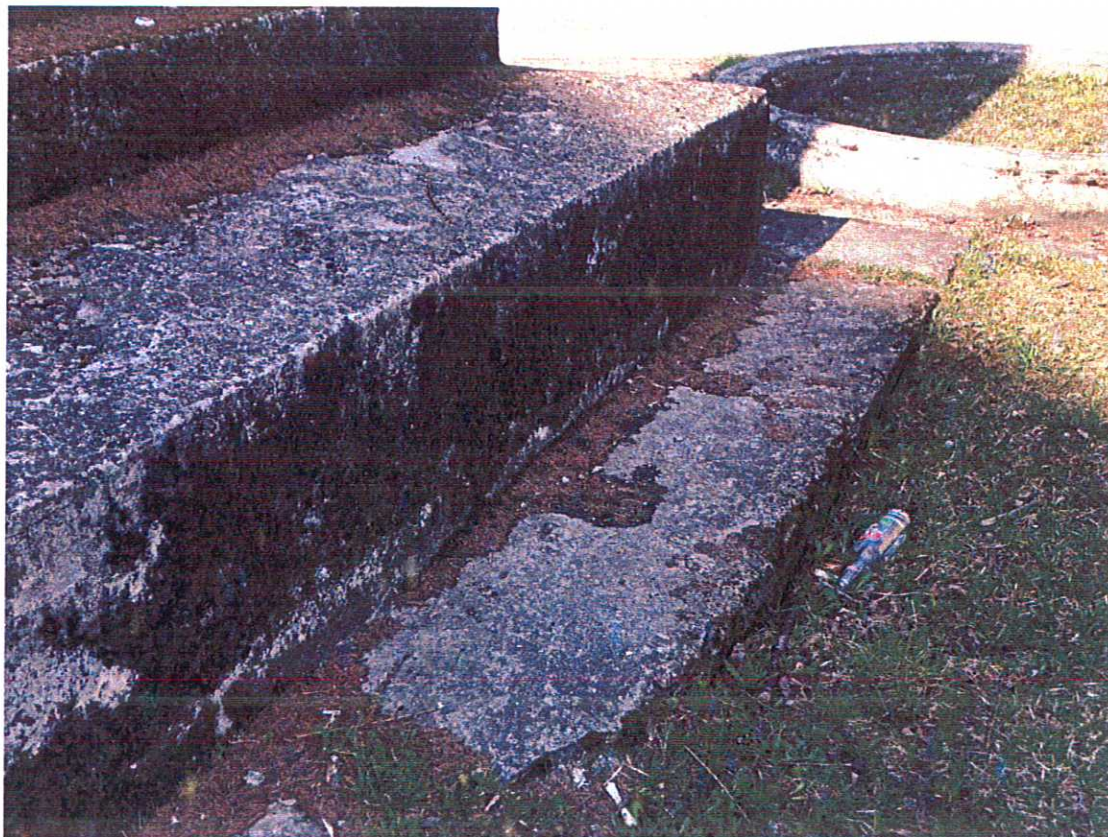
fot. nr 23 – Cokół pomnika. Widoczne zniszczenia i ubytki w betonie.
