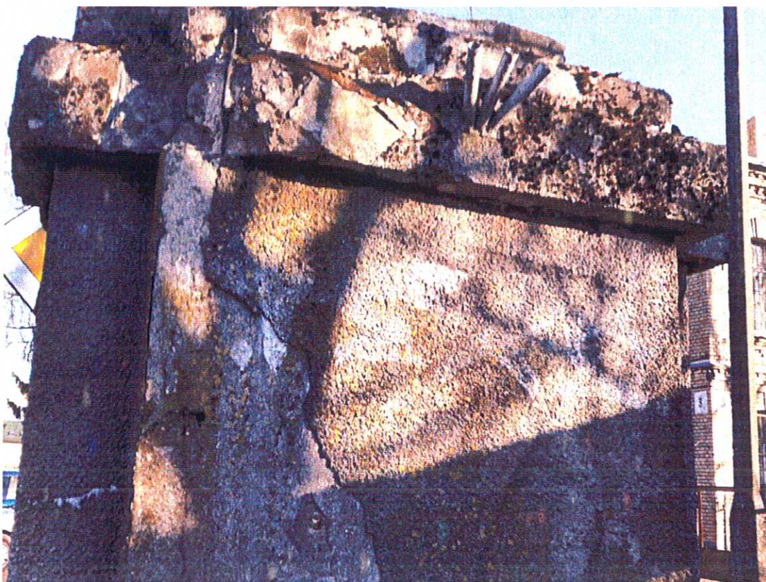
fot. nr 9 – Widoczne ubytki w kolumnie i metalowe elementy do demontażu.
