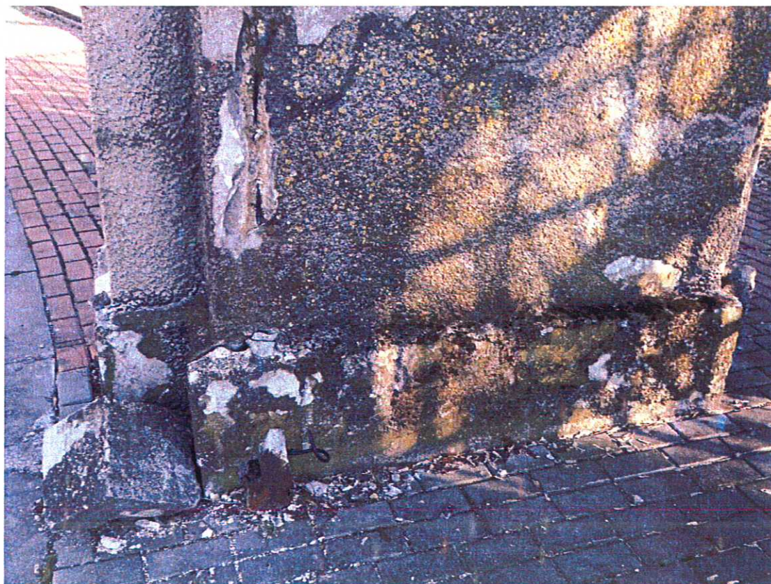
fot. nr 10 – Widoczne ubytki w kolumnie i metalowe elementy do demontażu.
