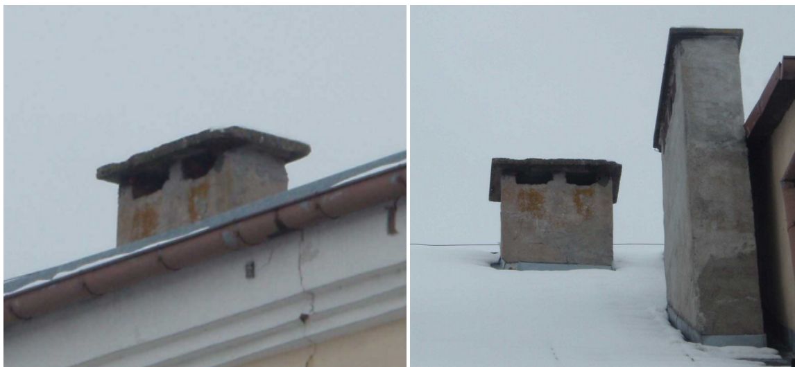
Zdjęcia nr 26. Zawilgocenie gzymsu.
