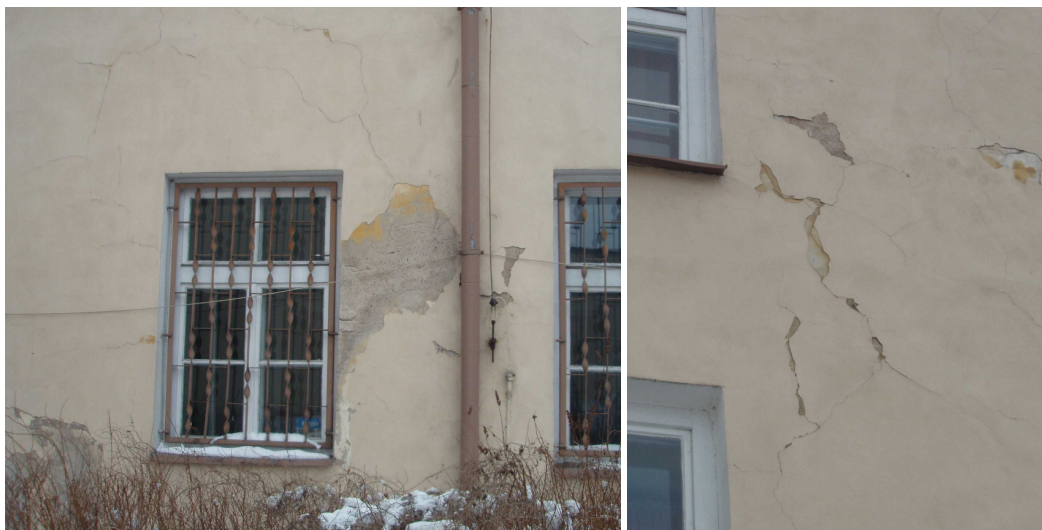
Zdjęcia nr 13, 14, 15. Pęknięcia ściany na całej grubości.
