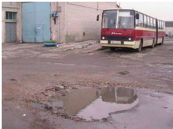
Fot. 23. Zajezdnia Zakładu Komunikacji Miejskiej PGK - stan techniczny nawierzchni.
