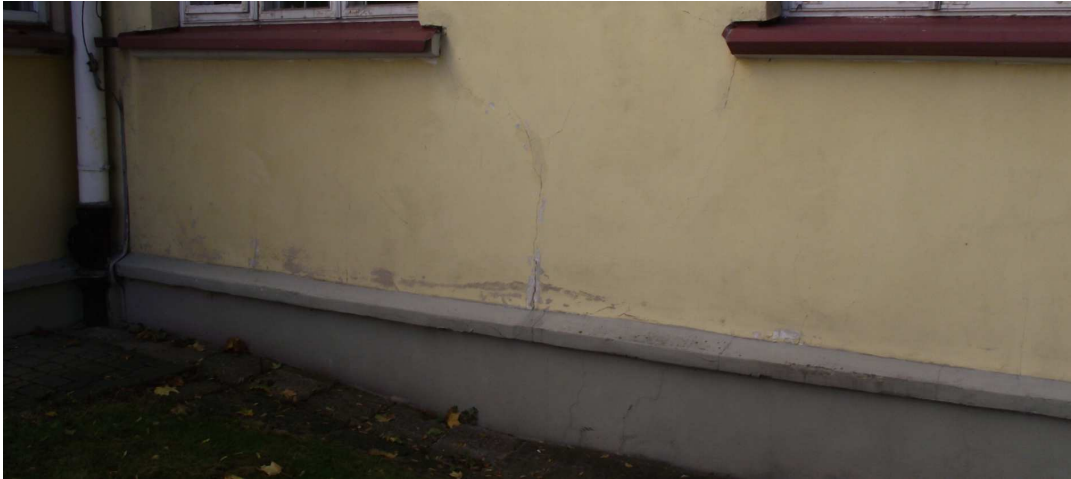
Pęknięcie ściany fundamentowej
