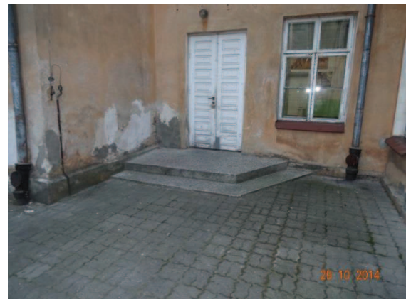
Fot. 18. Oficyna lewa. Zawilgocenia ścian przy wejściu od strony oficyny tylnej.
