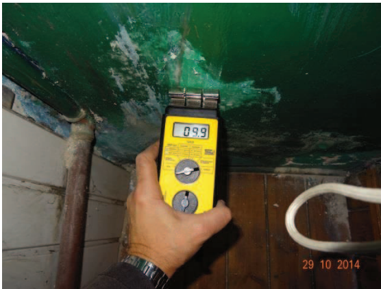
Fot. 45. Jak fot. 44, lecz pomiar wilgotności ściany wewnętrznej.
