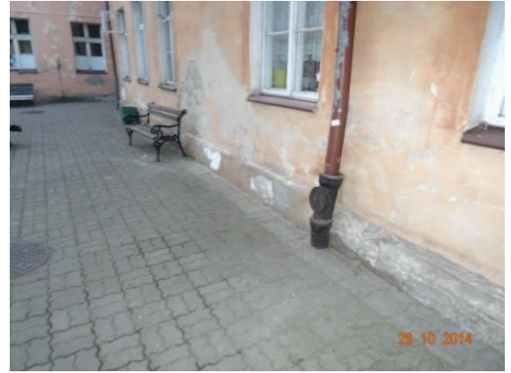
Fot. 16. Przykładowe uszkodzenia zawilgoconej ściany tylnej oficyny.
