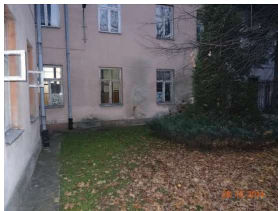
Fot. 24. Ściana tylna budynku mniejszego. Widoczne zawilgocenia na filarkach między okiennymi na całej wysokości parteru.
