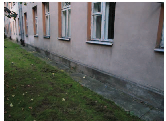
Fot. 30. Zawilgocenia dolnych fragmentów ściany oficyny prawej budynku mniejszego.
