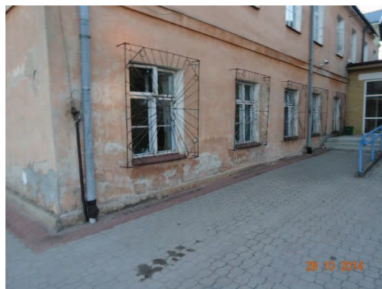
Fot. 22. Ściana tylna oficyny tylnej. Widoczne zawilgocenia dolnych fragmentów oraz liczne wyprawki tynku.
