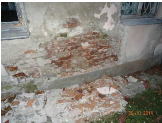
Fot. 26. Jak fot. 25, lecz zbliżenie na odsłonięty mur. Widoczne uszkodzenia korozyjne materiału ceramicznego.
