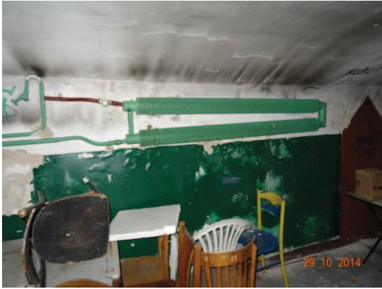
Fot. 49. Złuszczenia lamperii i tynku.
