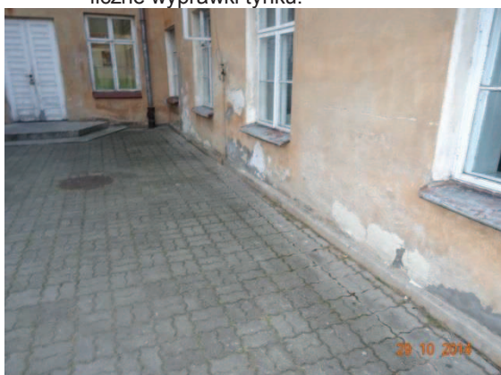
Fot. 20. Ściana frontowa oficyny tylnej. Widoczne zawilgocenia dolnych fragmentów oraz liczne wyprawki tynku.
