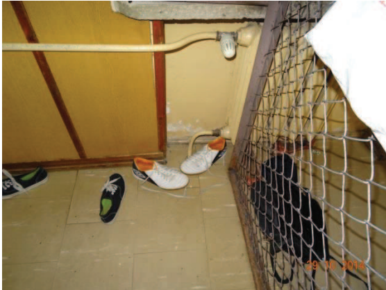
Fot. 37. Zawilgocenia podokiennika w strefie występowania i ubytku tynku pokazanego na fot. 25 i 26.
