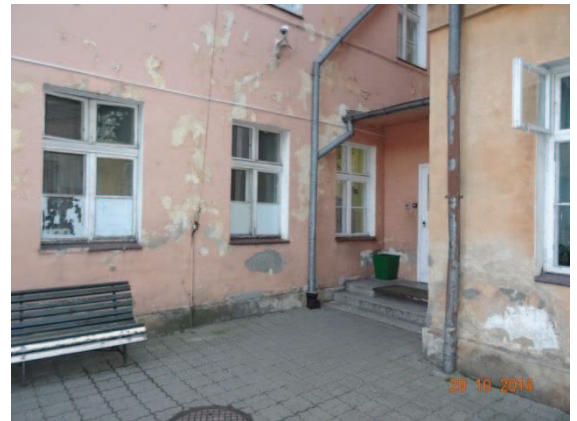
Fot. 17. Zawilgocenia w strefie połączenia oficyny lewej z budynkiem głównym.
