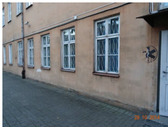
Fot. 10. Oficyna prawa budynku głównego. Widoczne zawilgocenia dolnych fragmentów ściany.
