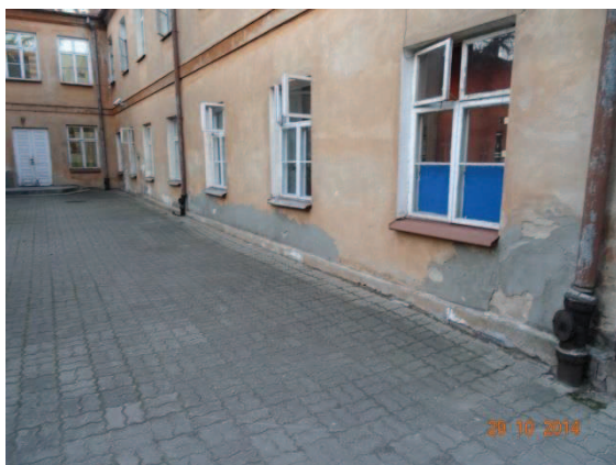
Fot. 19. Ściana frontowa oficyny tylnej. Widoczne zawilgocenia dolnych fragmentów oraz liczne wyprawki tynku.
