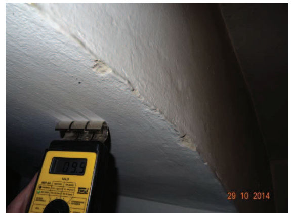
Fot. 48. Jak fot. 46, lecz pomiar wilgotności ściany na nadprożu łukowym.
