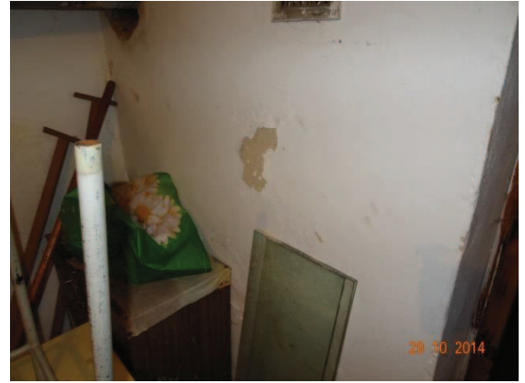
Fot. 51. Złuszczenia tynku z ściany działowej.
