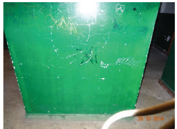
Fot. 41 i 42. Przykładowe Złuszczenia lamperii na ścianach wewnętrznych.
