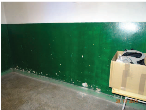
Fot. 39. Przykładowe złuszczenia lamperii na ścianie wewnętrznej.
