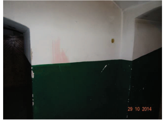
Fot. 46. Złuszczenia lamperii z zawilgoconej ściany wewnętrznej.
