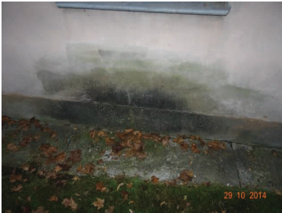
Fot. 32. Zbliżenie na podokiennik intensywnie zawilgocony i porażony przez mchy i porosty wskutek przecieków wody opadowej z uszkodzonej i zanieczyszczonej rynny.
