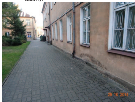
Fot. 11. Jak fot. 10, lecz dalszy fragment. Na pierwszym planie widoczne porażenie tynku
