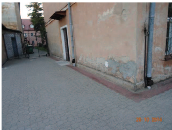
Fot. 21. Ściana szczytowa oficyny tylnej. Widoczne zawilgocenia dolnych fragmentów oraz liczne wyprawki tynku.
