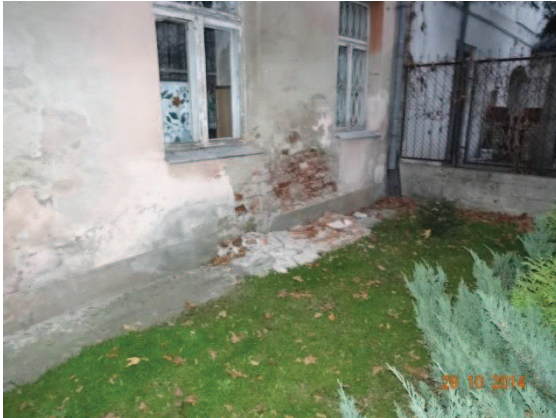
Fot. 25. Ściana tylna budynku mniejszego. Fragment przy ścianie szczytowej. Widoczny rozległy ubytek tynku zewnętrznego
