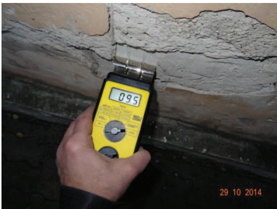
Fot. 15. Jak fot. 14, lecz pomiar wilgotności w strefie ubytku tynku.
