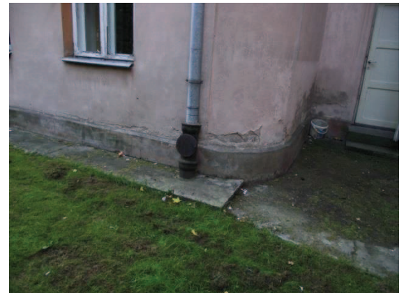
Fot. 29. Oficyna prawa budynku mniejszego. zawilgocenia naroża ściany.
