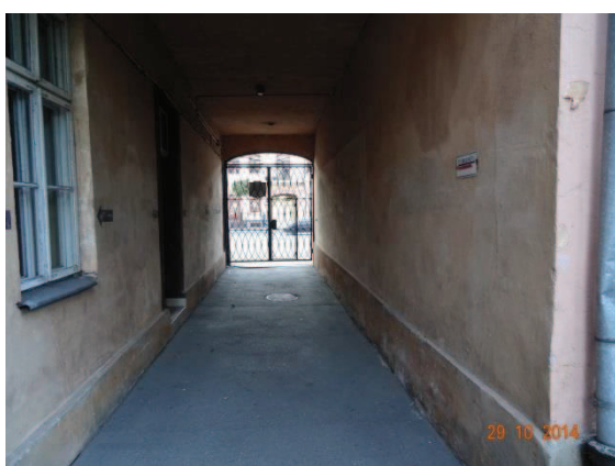
Fot. 8. Brama wjazdowa. Widoczne zawilgocenia ścian bocznych do poziomu ok. 1,5 m.
