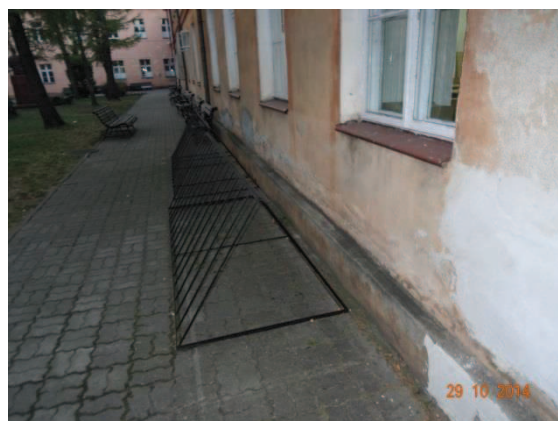
Fot. 12. Oficyna lewa. Zawilgocenia dolnych fragmentów ściany.
