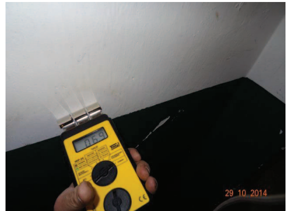
Fot. 47. Jak fot. 46, lecz pomiar wilgotności ściany nad lamperią.
