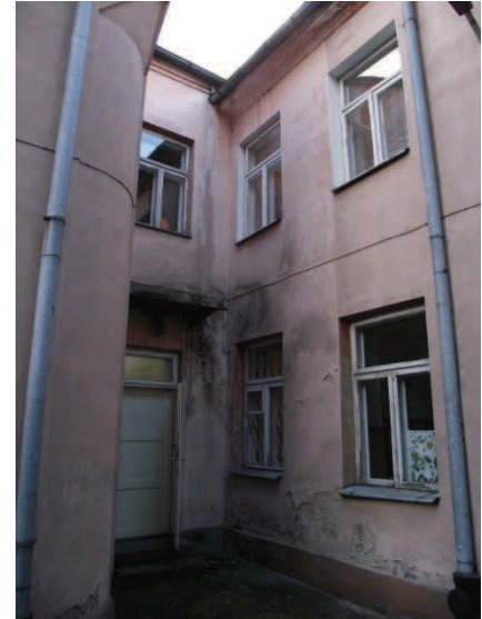
Fot. 28. Tylna ściana budynku mniejszego. Widoczne zawilgocenia dolnych fragmentów oraz intensywne zawilgocenia w poziomie stropu nad parterem spowodowane ściekaniem wody opadowej z uszkodzonych rynien.
