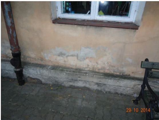
Fot. 13 i 14. Przykładowe uszkodzenia zawilgoconej ściany tylnej oficyny.
