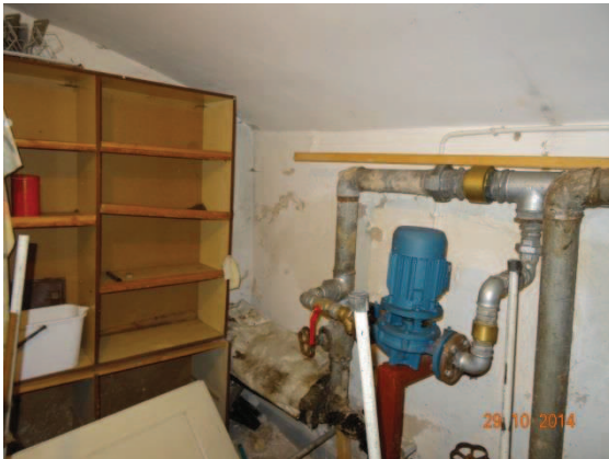
Fot. 50. Zawilgocenia ściany w węźle cieplnym.
