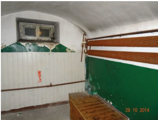
Fot. 43 i 44. Przykładowe zawilgocenia ściany zewnętrznej i ścian wewnętrznych.
