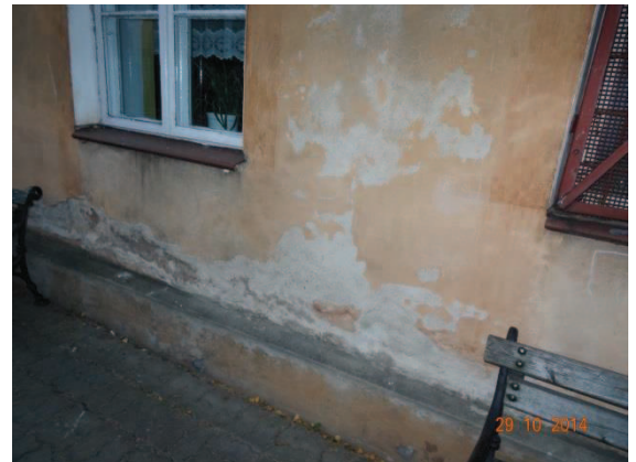
Fot. 5. Ściana tylna budynku głównego. Przykładowe zawilgocenia dolnych fragmentów ściany i będące ich skutkiem uszkodzenia tynku zewnętrznego.
