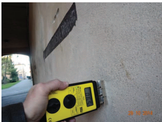
Fot. 9. Przykładowy pomiar wilgotności ściany bocznej bramy przejazdowej.
