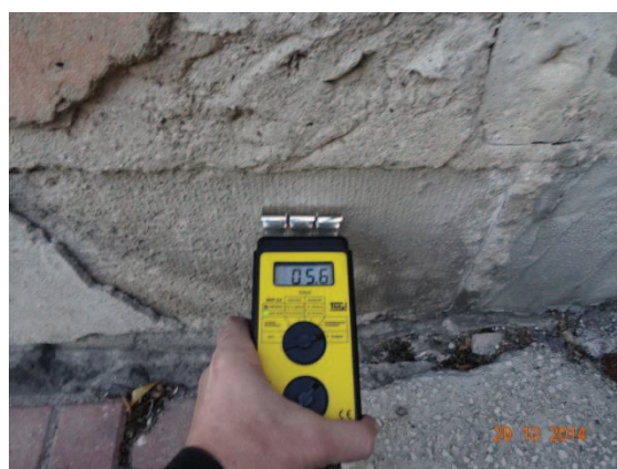
Fot. 23. Pomiar wilgotności ściany w miejscu ubytku tynku przy schodach.
