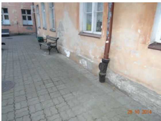
Fot. 7. Ściana tylna budynku głównego. Przykładowe zawilgocenia dolnych fragmentów ściany i będące ich skutkiem uszkodzenia tynku zewnętrznego.
