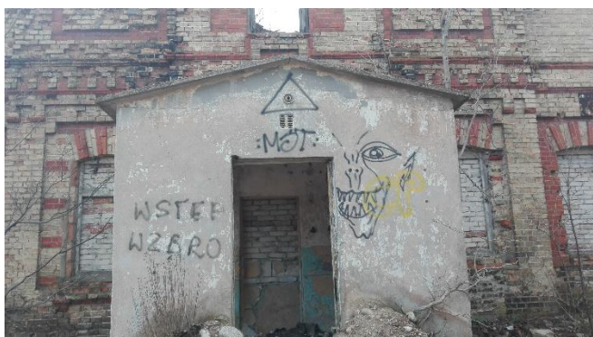
ZDJĘCIE 8C – DOBUDOWANY ELEMENT
