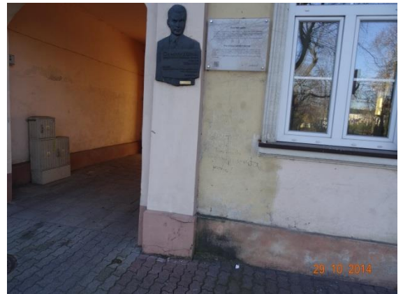
Fot. 17. Zawilgocenia ściany frontowej domu Miłoszów.
