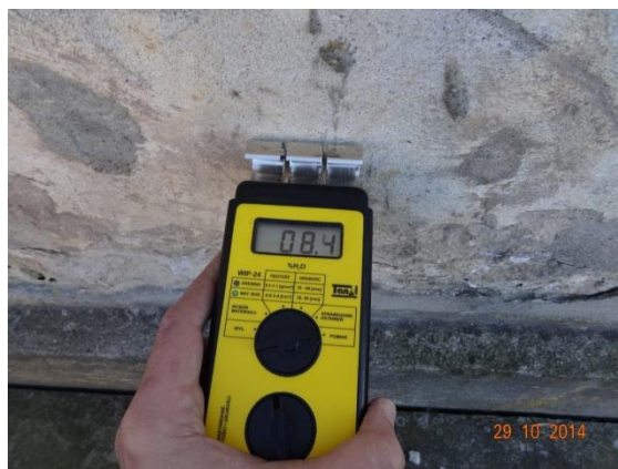
Fot. 34. Pomiar wilgotności muru między otworami górnego rzędu iniekcji – pomierzona wartość maksymalna.
