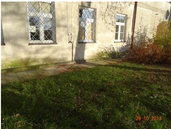
Fot. 39. Tylna ściana budynku frontowego. Widoczne zawilgocenia oraz porażenia elewacji przez porosty.
