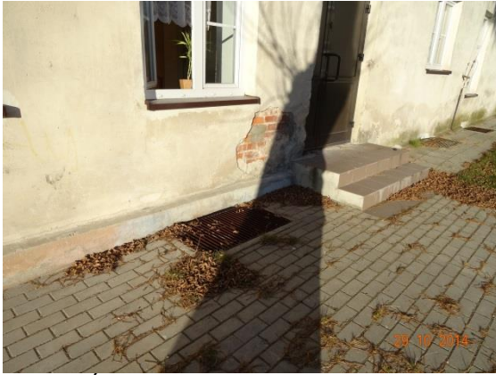
Fot. 37. Ściana frontowa oficyny. Widoczne zawilgocenia dolnych fragmentów ściany.
