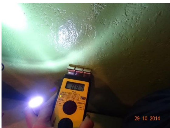
Fot. 43 – 46. Pomiary wilgotności ścian w szatniach.
