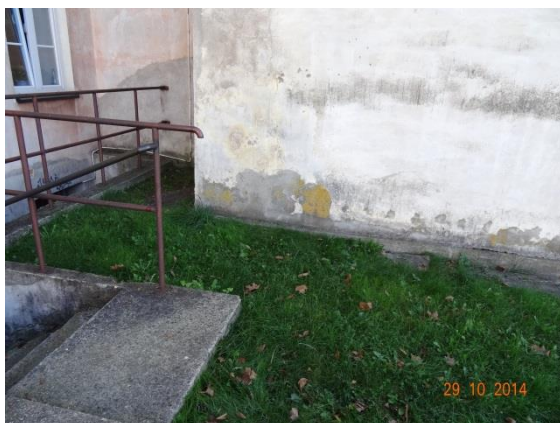
Fot. 31. Naroże jak na fot. 30. Widoczny brak otworów iniekcyjnych przy bark przy narożu. Dalej iniekcja jednorzędowa.
