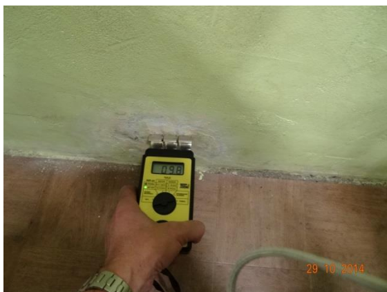
Fot. 50. Pomiar wilgotności dolnych fragmentów ściany w izbie lekcyjnej zaadaptowanej z dawniejszego składu opału.
