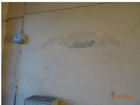
Fot. 19. Zawilgocenia i złuszczenia tynku nad wymienionym tynkiem.
