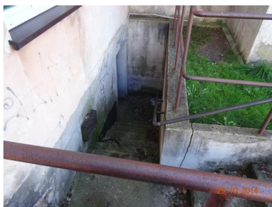
Fot. 29. Stan zawilgoczeń wejścia zewnętrznego do piwnic przy dawniejszym składzie opału.
