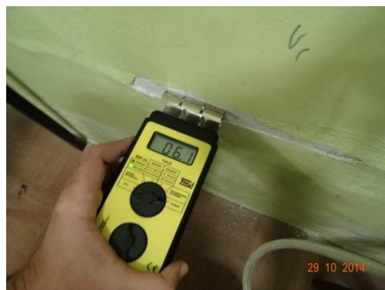
Fot. 49. Pomiar wilgotności dolnych fragmentów ściany w izbie lekcyjnej zaadaptowanej z dawniejszego składu opału.
