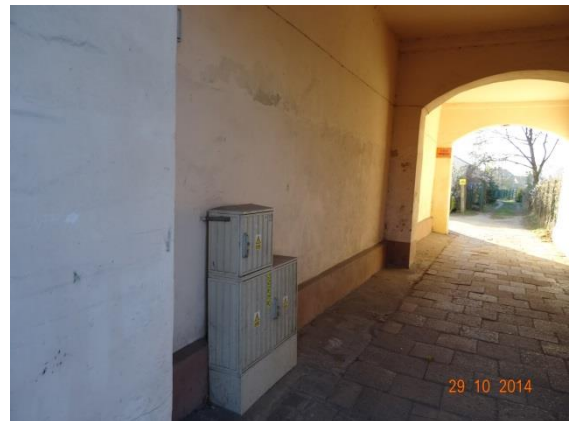
Fot. 18. Ściana lewa bramy przejazdowej. Widoczne ślady wymiany tynku do poziomu ok. 2,0 m nad posadzkę.
