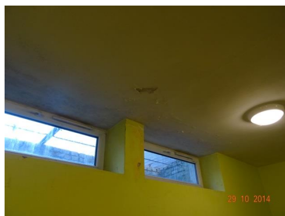
Fot. 47 i 48. Zawilgocenia stropu i górnych fragmentów ściany w izbie lekcyjnej zaadaptowanej z dawniejszego składu opału.
