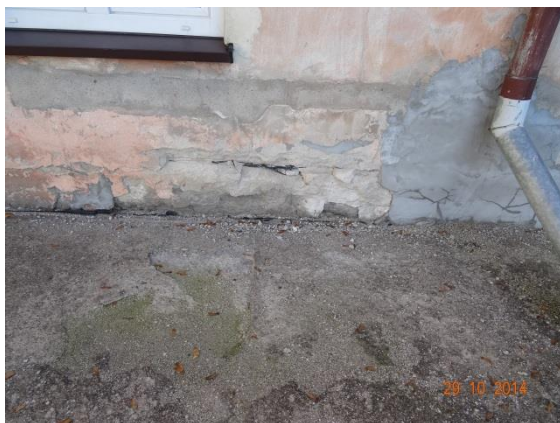
Fot. 26 i 27. Ściana tylna budynku. Zawilgocenia i uszkodzenia dolnych fragmentów ściany nad dawniejszym składem opału.
