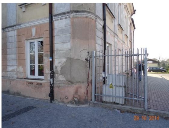
Fot. 21. Prawe naroże budynku. Widoczne zawilgocenie narastające w narożu.
