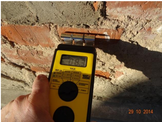
Fot. 38. Pomiar wilgotności muru w miejscu ubytku tynku widocznego na fot. 37.
