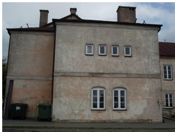
Fot. 24. Zawilgocenia ściany szczytowej budynku skrajnego.
