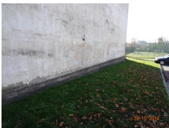
Fot. 32. Widok dolnych fragmentów ściany ze śladami dwóch rzędów otworów iniekcyjnych.
