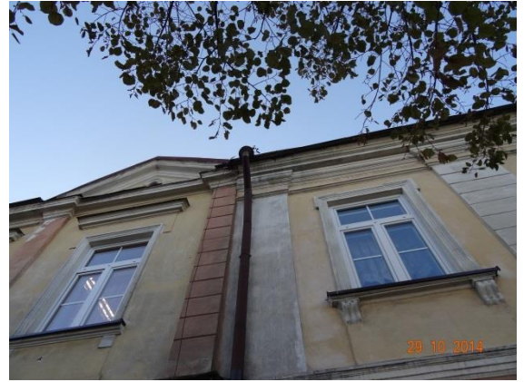
Fot. 16. Uszkodzenia i niedrożności rynien nad strefą pokazaną na fot. 15.
