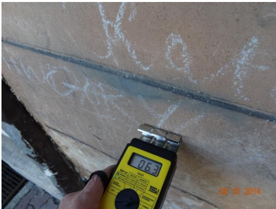
Fot. 13 i 14. Stan zawilgoceń ściany na lewo od Otworu drzwiowego.
