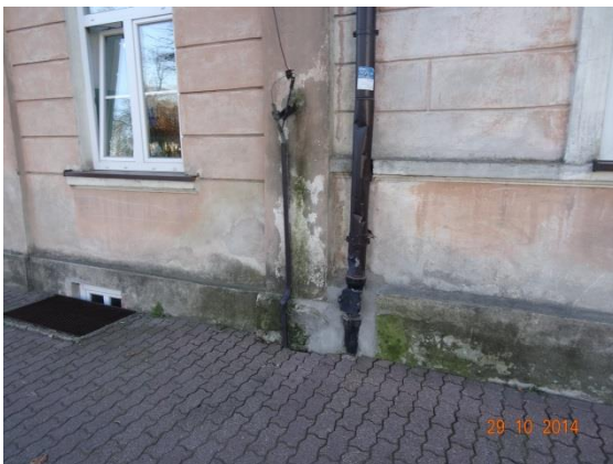
Fot. 15. Przykładowe porażenia dolnych fragmentów ścian przez porosty w następstwie zawilgoceń wodą opadową z niesprawnych rynien i rur spustowych.
