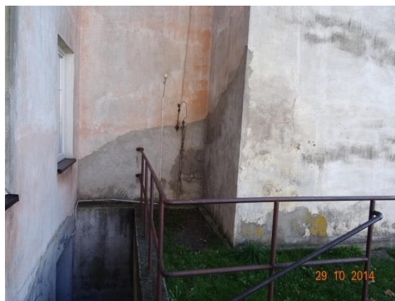
Fot. 30. Narastające zawilgoczenia w narożu ściany oficyny przy ścianie podłużnej budynku frontowego.
