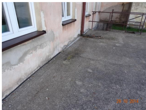
Fot. 28. Ściana tylna. Zawilgocenia i uszkodzenia dolnych fragmentów ściany nad dawniejszym składem opału.
