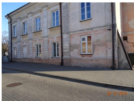
Fot. 23. Zawilgocenia ściany bocznej narastające w narożu.
