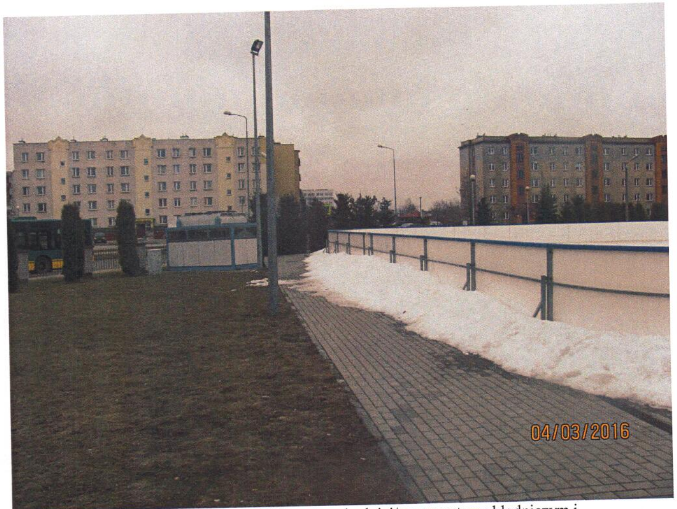
Fot nr 1 widok od strony ulicy Daszyńskiego / wschodniej/ z agregatem chłodniczym i lampami oświetleniowymi do demontażu
